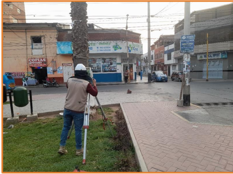
Se observa los trabajos de levantamiento topográfico de las intersecciones del Jr. Huallayco y el Jr. Damaso Beraún.
