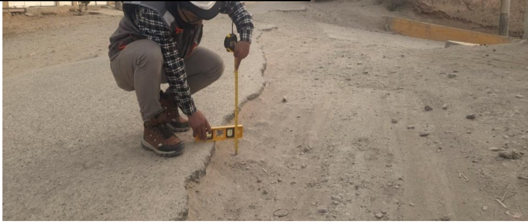
Se puede observar el desprendimiento de pavimento en los bordes de la Av. Perú
