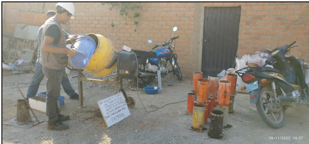
SE OBSERVA LA FABRICACIÓN DEL CONCRETO SEGUN DISEÑO CON ADHESIÓN DE LA FIBRAS.
