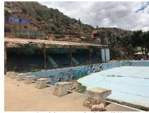
Area de la piscina en abandono - 05.22
