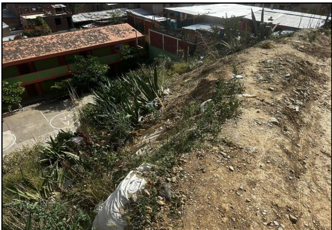
La ladera se sostiene con costales de tierra, ocasionando inestabilidad, como se observa en la imagen hay un colegio en la parte baja.
