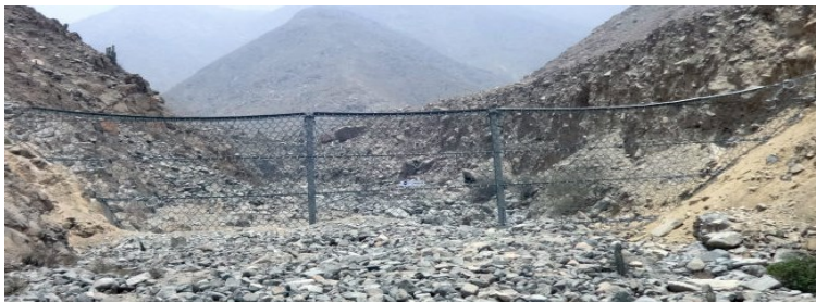
Figura 6 Zona de acumulación
