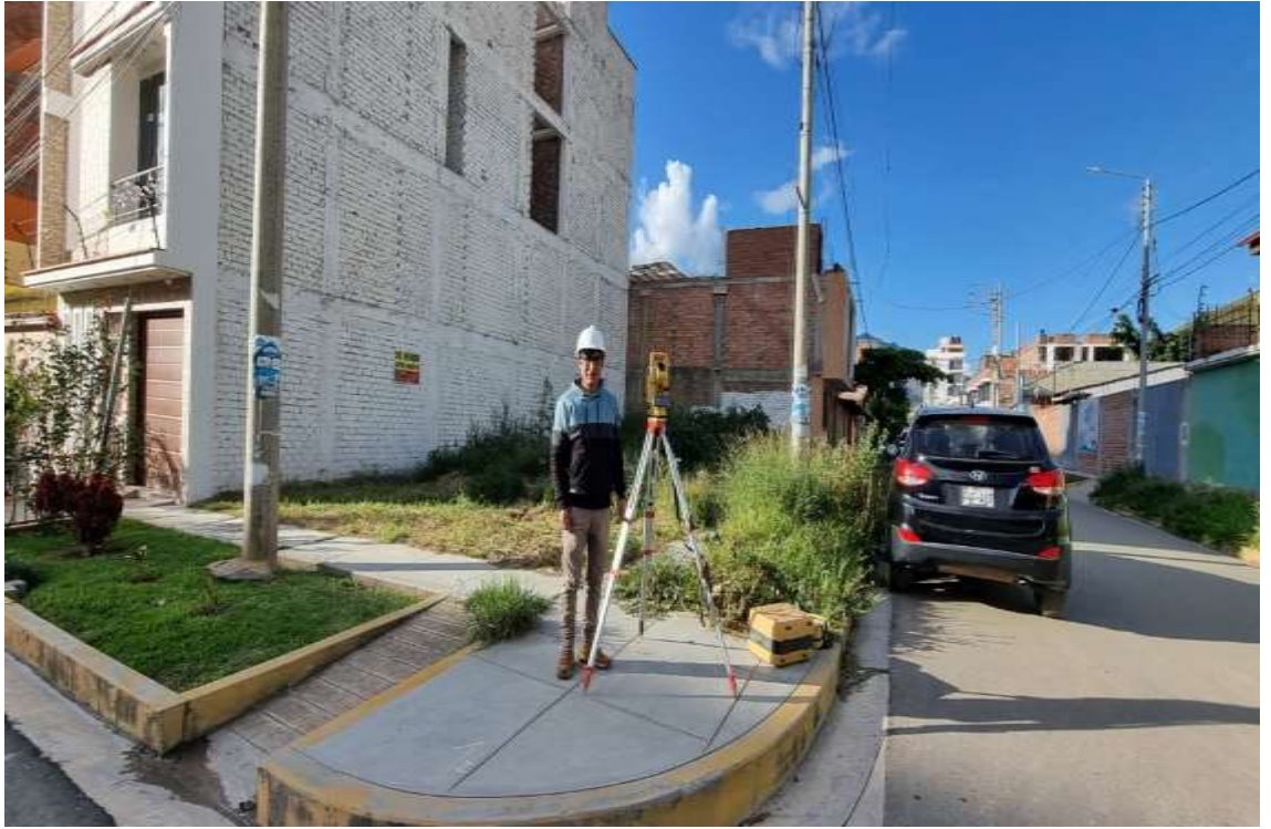
La imagen muestra el inicio del levantamiento topográfico del terreno, para tomar puntos del área, perímetro, y otros componentes que presenta el terreno como la vereda, las calles y viviendas colindantes.
