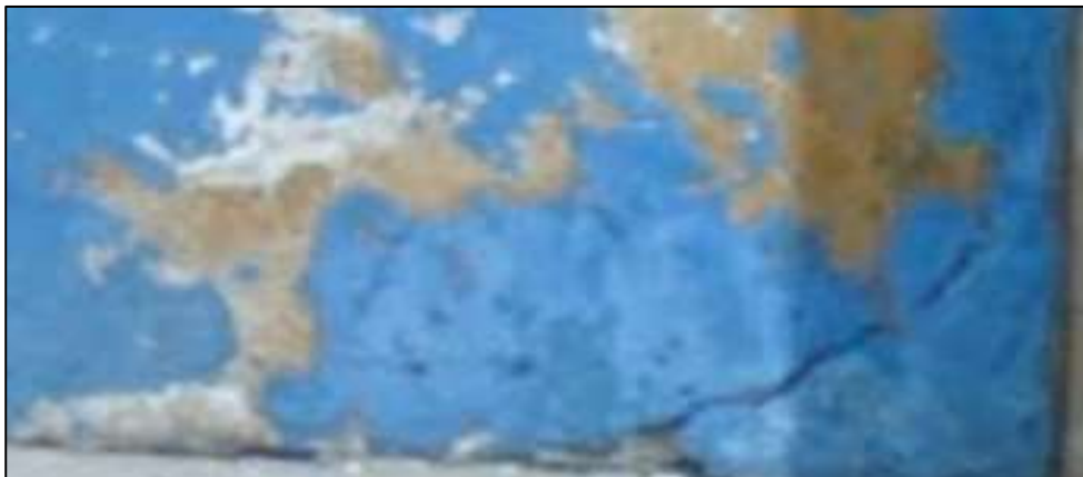
Evidencia de fisuras en la vivienda 1058 del Jr. Hermilio Valdizán la cuadra 10
