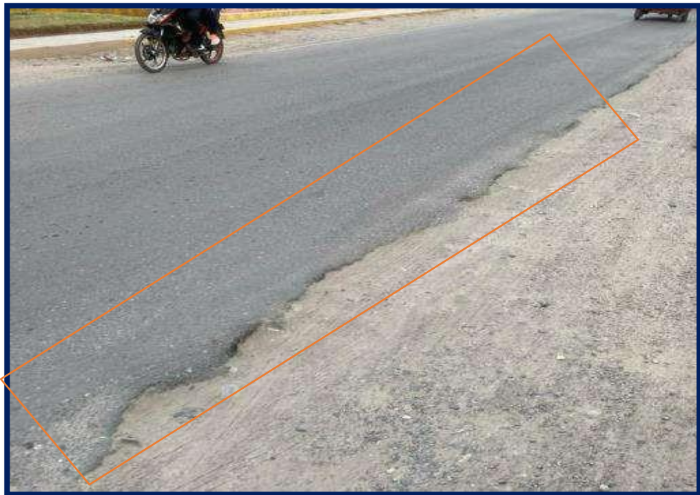
Piel de cocodrilo, ubicado en la muestral N.º UM70, del tramo la Av. Universitaria, PILLCO MARCA, HUÁNUCO.
