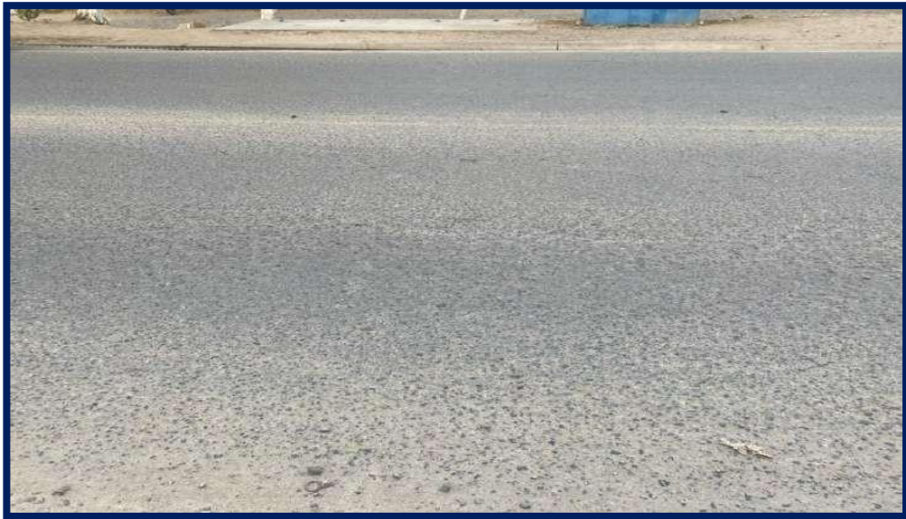
Grietas en borde, ubicado en la muestral N.º UM54, del tramo la Av. Universitaria, PILLCO MARCA, HUÁNUCO.
