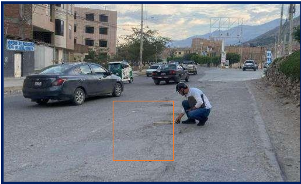
Pulimiento de agregados, ubicado en la muestral N.º UM38, del tramo la Av. Universitaria, PILLCO MARCA, HUÁNUCO.
