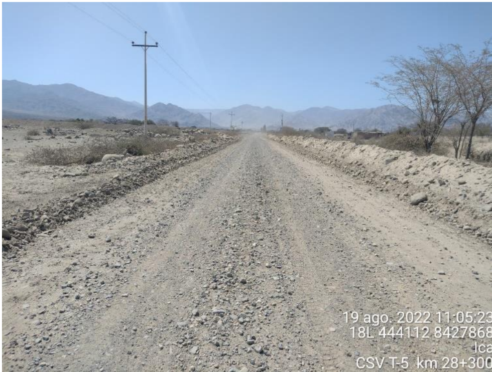
Fotografía 83 Perdida de la superficie de rodadura
