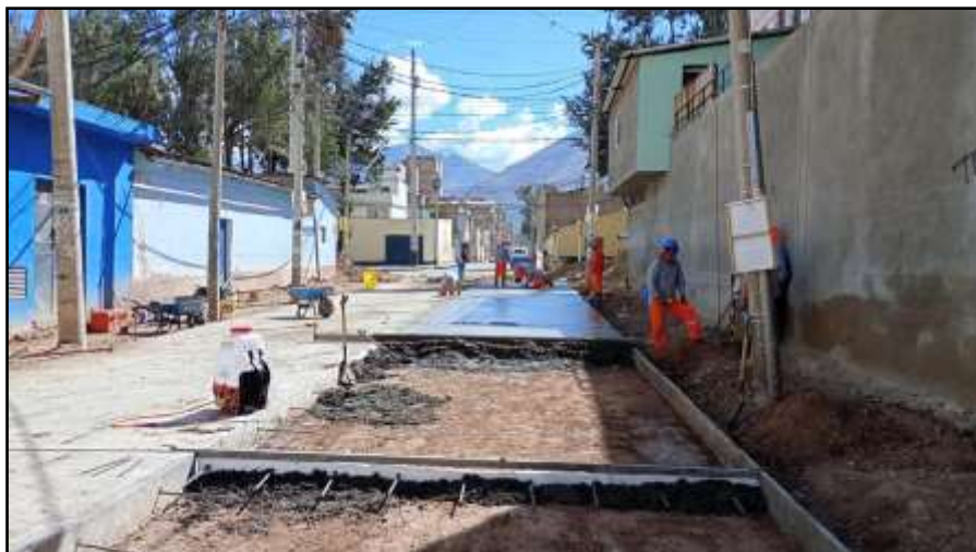
La pavimentación sobre las superficies de las calles para mejorar su funcionalidad, durabilidad y estética
