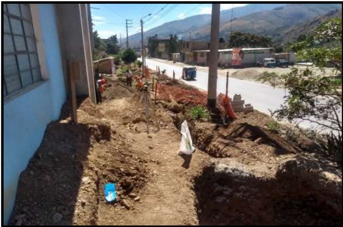
18: Se puede observar en la fotografía que se realizan los trabajos de excavación en el frente de trabajo barrio san juan.
