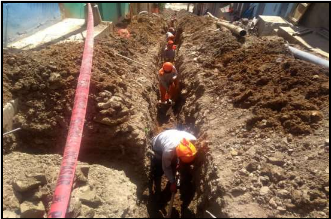
26: Se puede apreciar al personal obrero con los EPP, así mismo en este frente de trabajo no se nota el orden y limpieza en el borde de las zanjas el mismo que puede ser perjudicial, ya que podría desmoronarse y volver a caer a la zanja.
