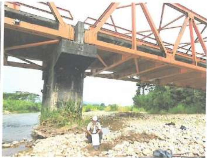
FOTOGRAFÍA N° 03: vista fotográfica del procedimiento de exploración y recolección de muestras correspondientes a la calicata C-03
