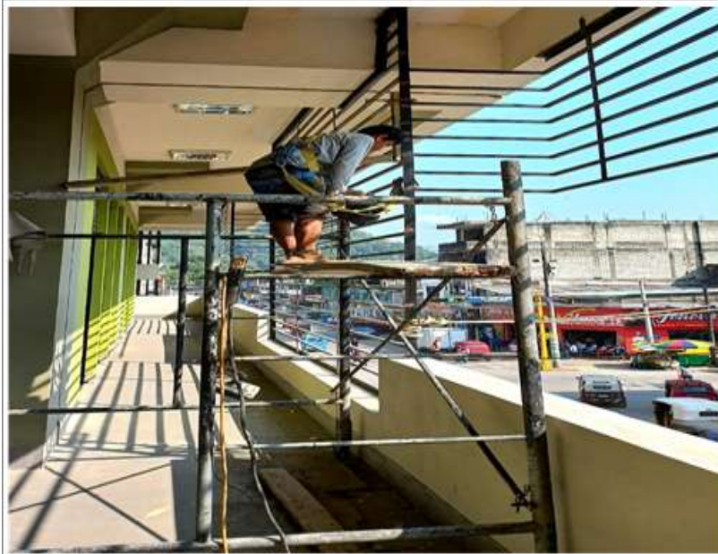
Se observa el proceso de instalación de parasoles en la fachada del Jr. Cayumba.
