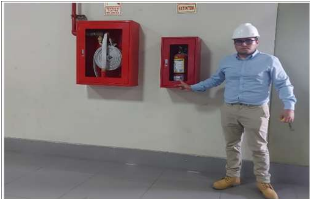
Se aprecia el resultado del apoyo en la dirección de instalación de caja de extintores contra incendio.
