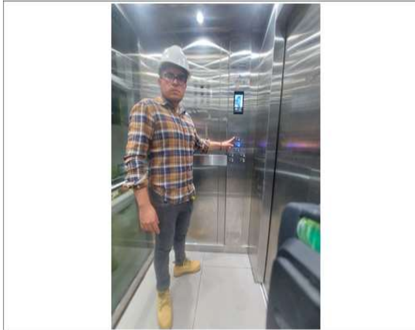
En la imagen se observa el apoyo en la verificación del funcionamiento del ascensor instalado.
