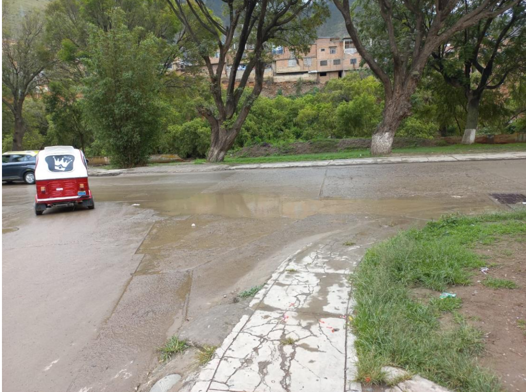
Empozamiento de aguas en el pavimento
