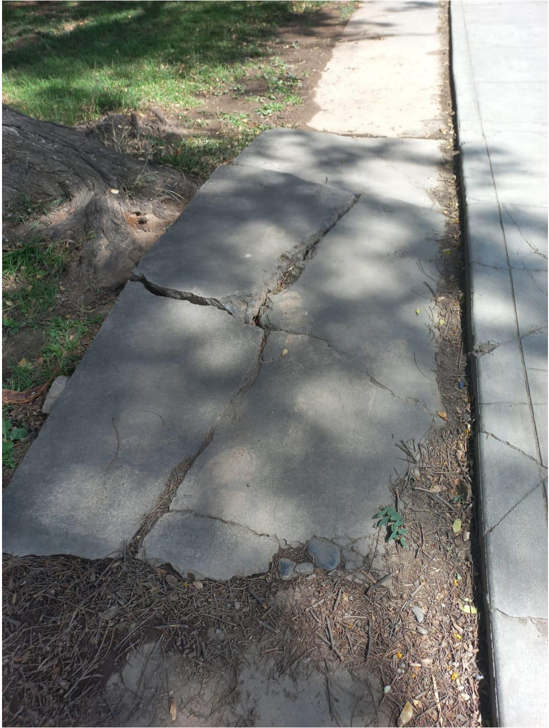
Falla de la vereda debido a la raíz del árbol
