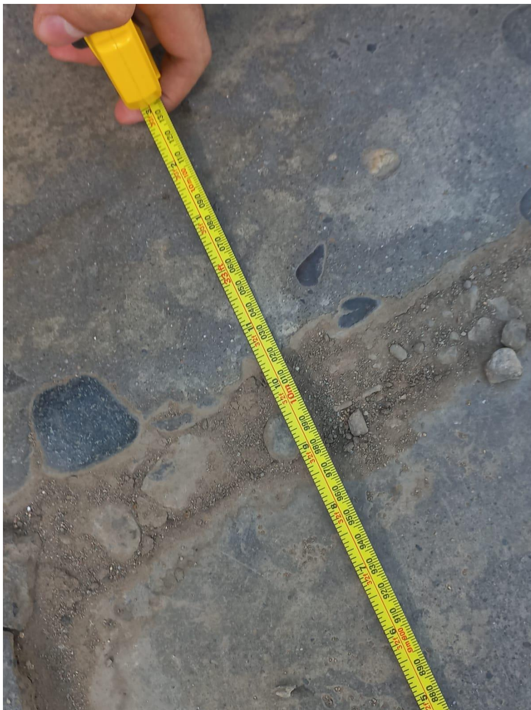
Ubicación final de la losa de 10 metros de distancia entre juntas transversales
