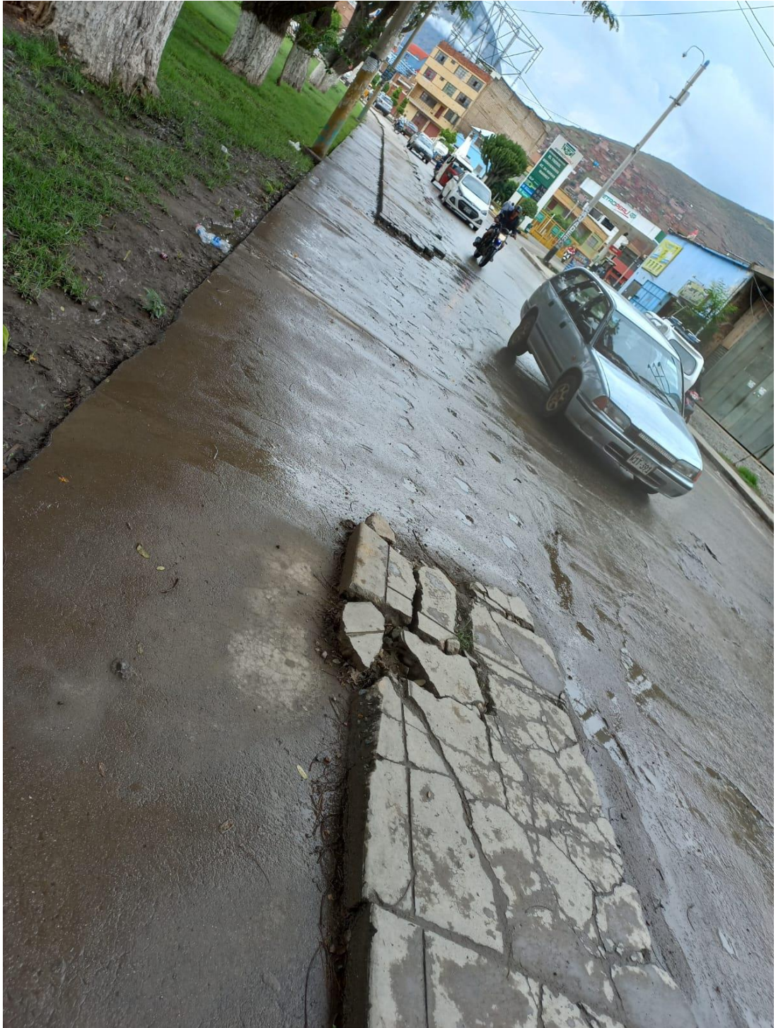
Zona de riesgo peatonal
