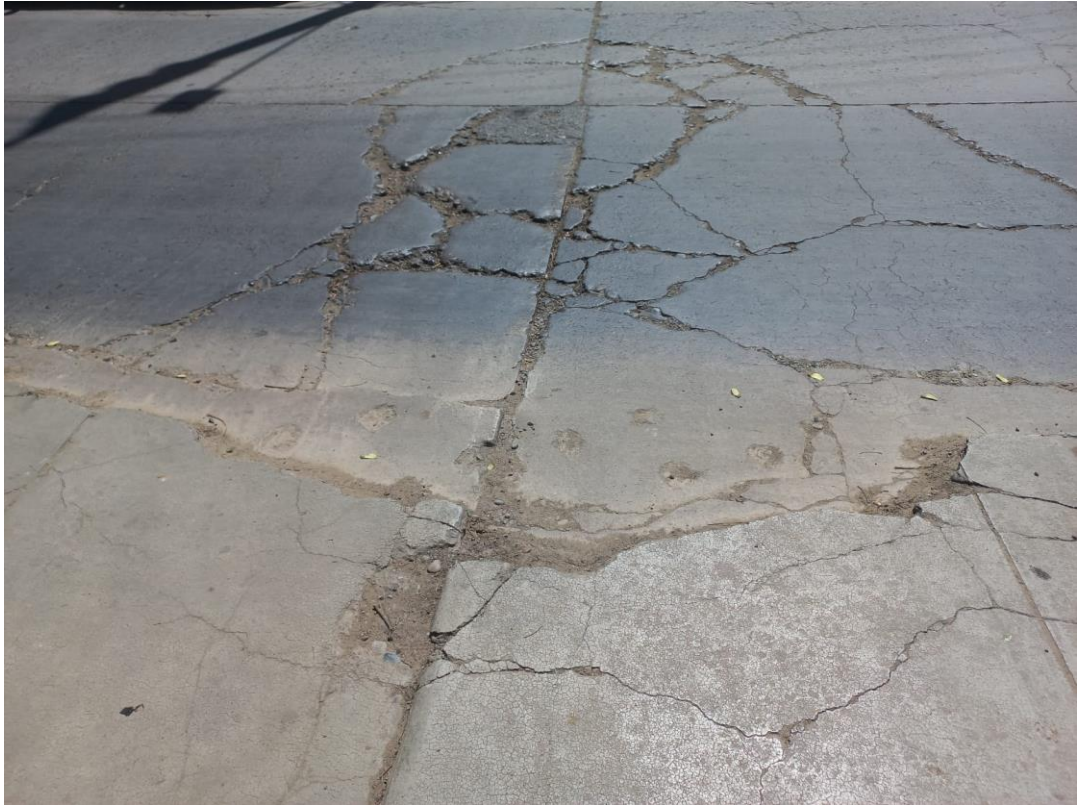
Falla del pavimento en las juntas
