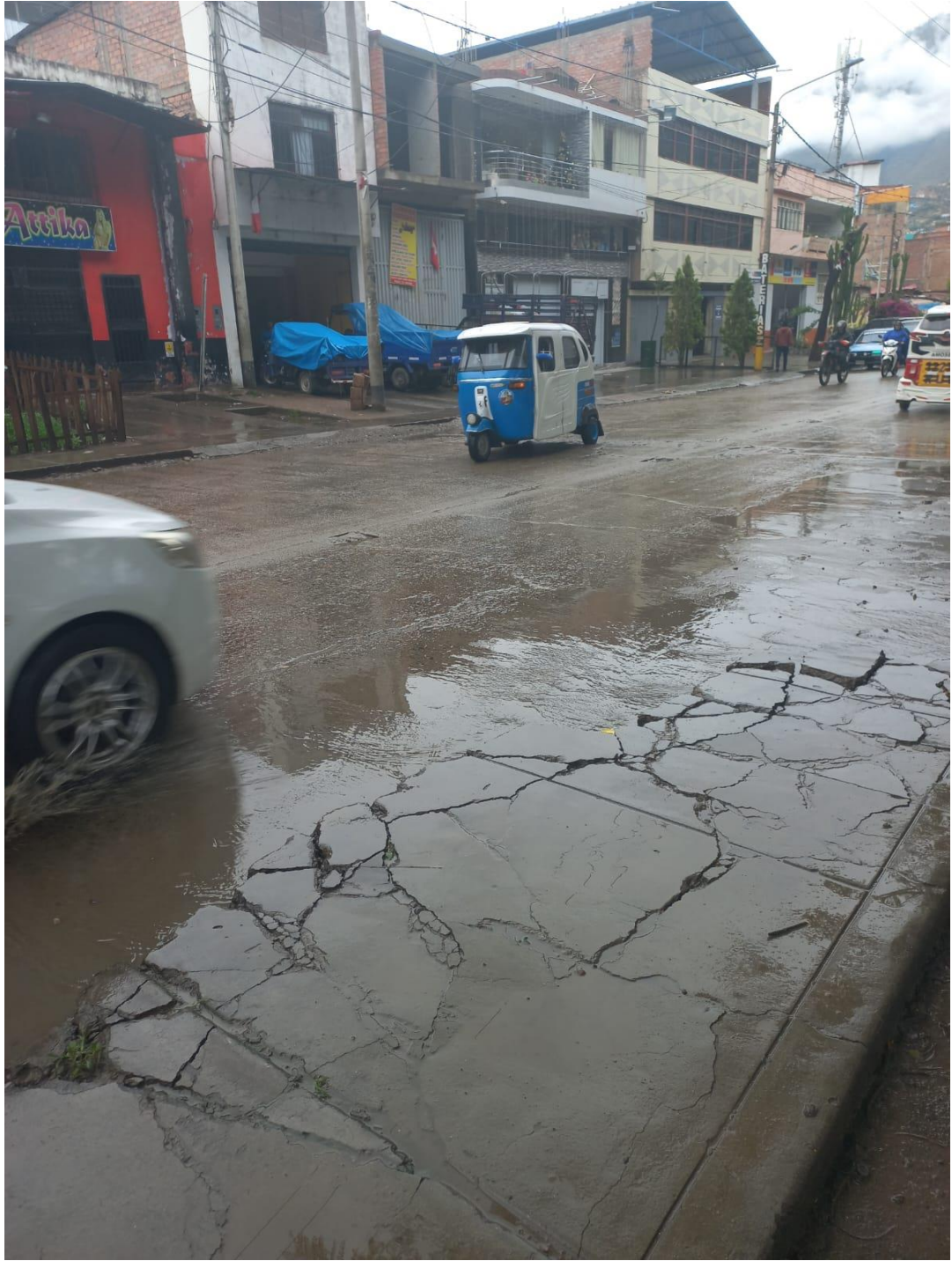
Falta de drenaje en el pavimento
