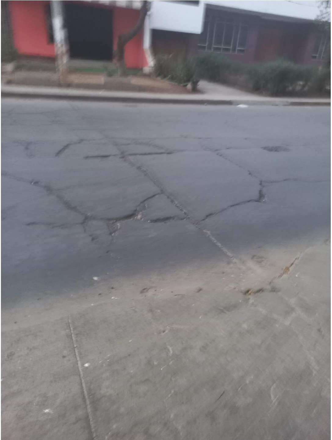
Fallo de ambas calzadas en la vía
