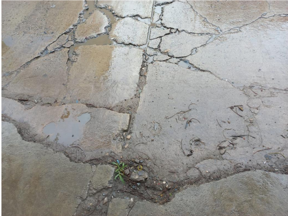
Falla en el borde del pavimento
