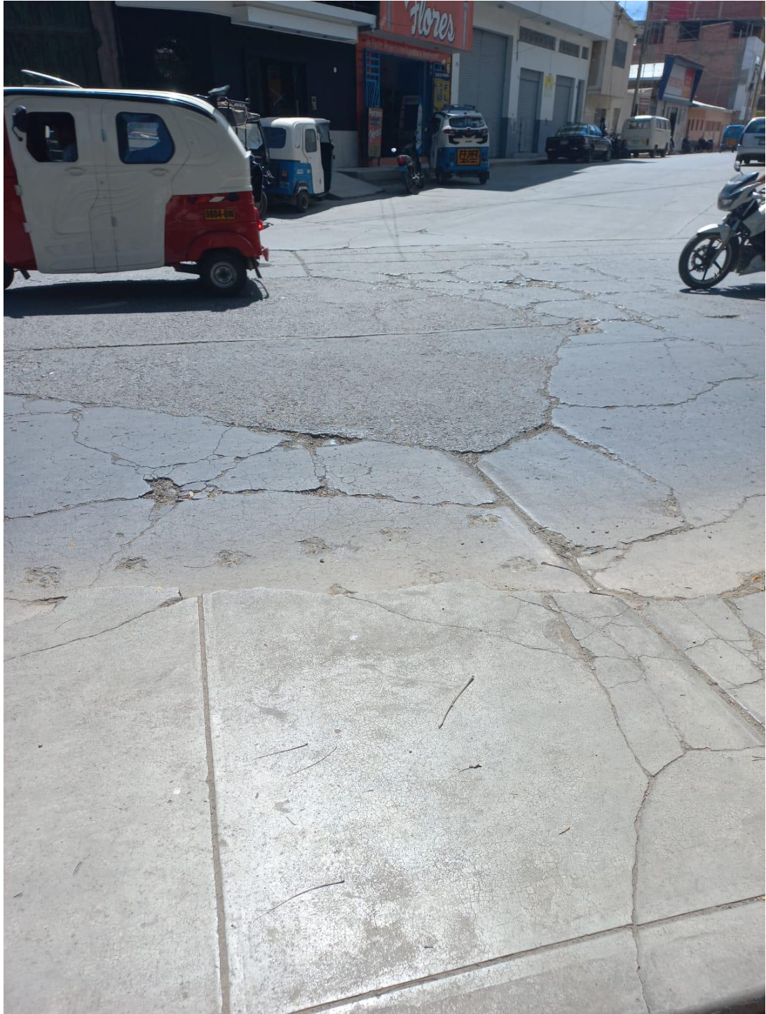
Mala práctica de mantenimiento de pavimento
