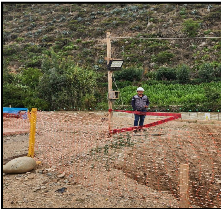
FOTOGRAFÍA N°21: ILUMINACIÓN PARA MURO DE CONTENCIÓN
