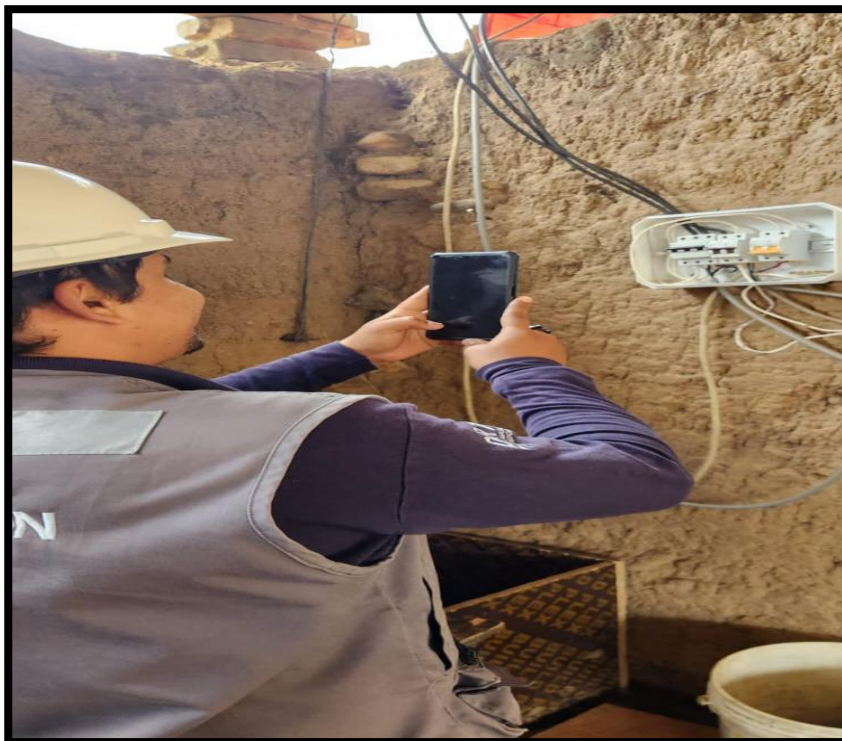
FOTOGRAFÍA N°18: SISTEMA ELÉCTRICO PARA ALUMBRADO
