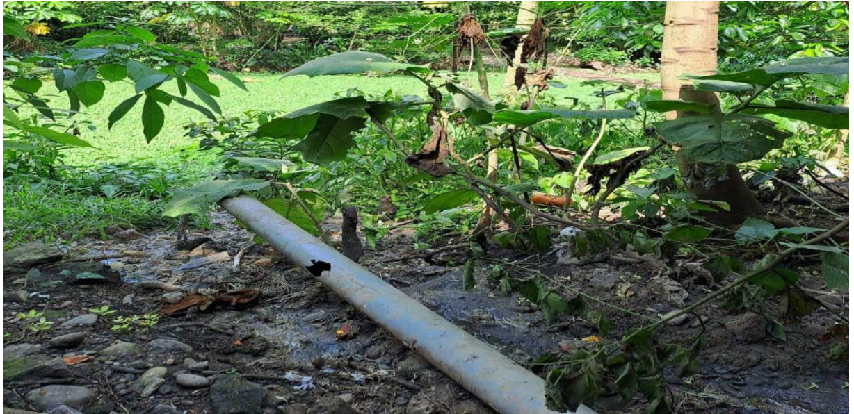
Imagen 01: Se realizó la visita a campo, para constatar que el agua proveniente de esta avícola va directamente a un riachuelo sin previamente haber sido tratada, contaminando así este recurso hídrico.
