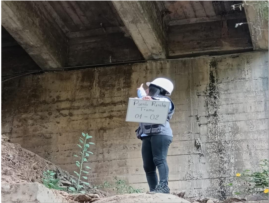
Se observa las vigas transversales en las líneas de apoyo con mohos propios de la humedad
