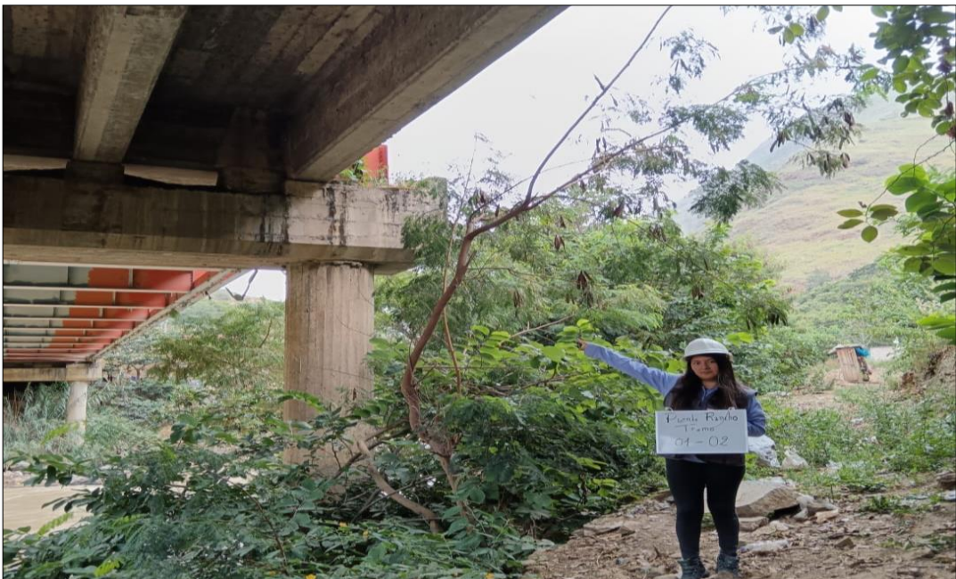
Se observa las vigas transversales en las líneas de apoyo con hogos propios de la humedad
