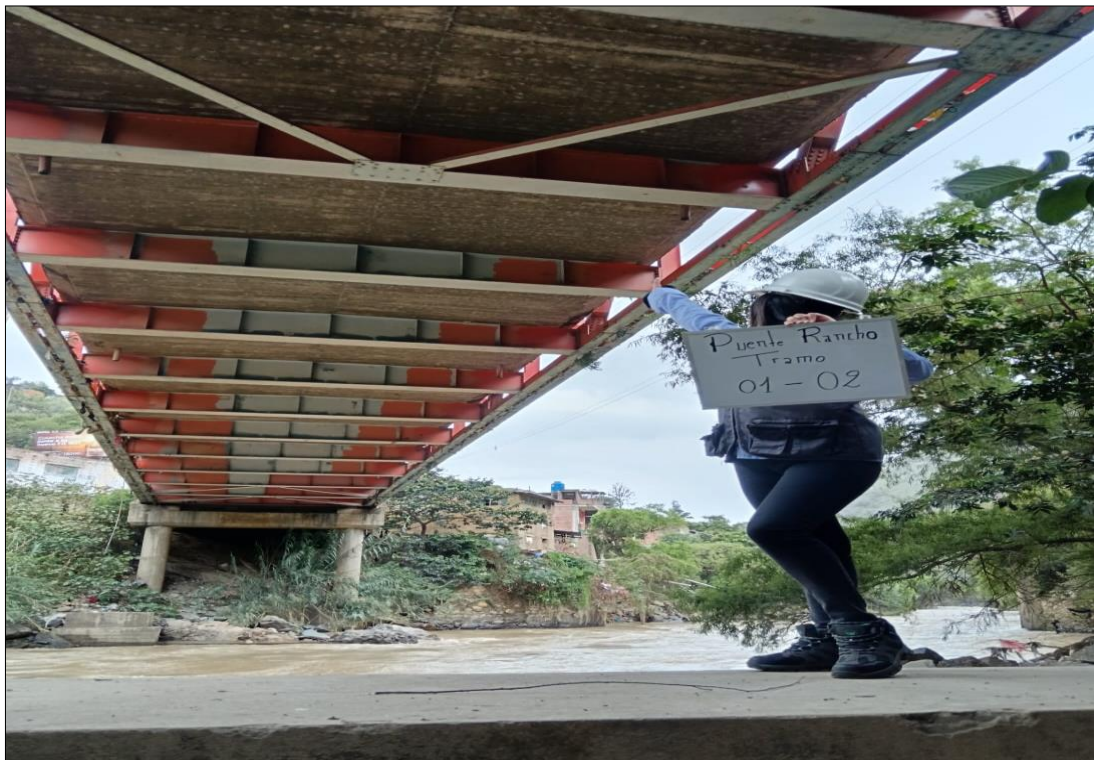
Se observa la parte inferior de la losa del puente, algunas patologías como la humedad
