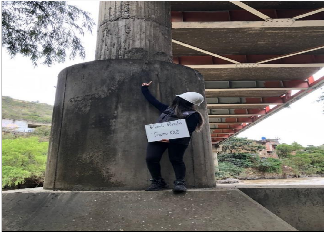
Se observa las pilas del puente con evidencias de manchas propias de la humedad
