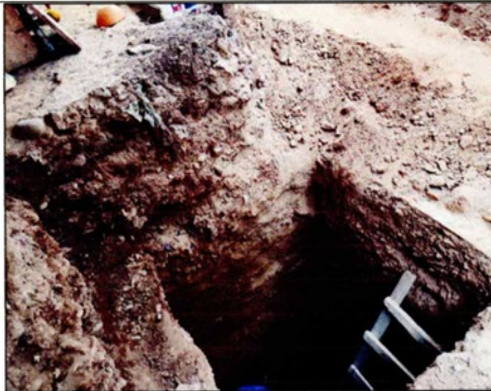
FOTO N° 05: Calicata N°01, vista del relleno no controlado, el cual se recomienda retirar.
