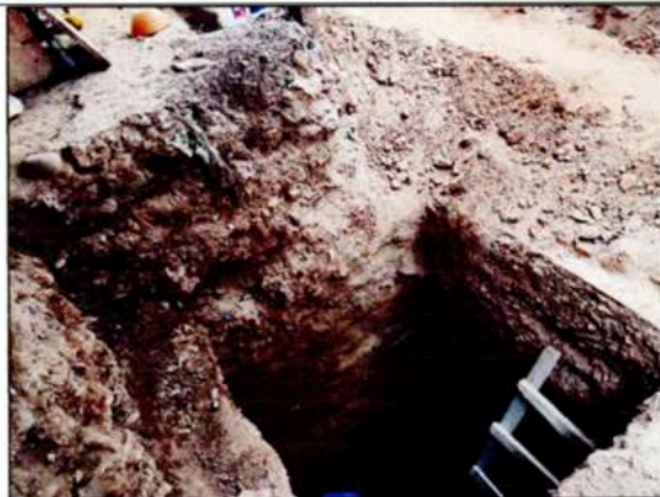
FOTO N° 05: Calicata N°01, vista del relleno no controlado, el cual se recomienda retirar.
