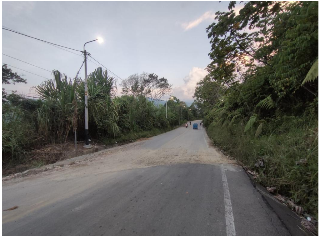
Fotografía 4 Hundimiento de suelos en carretera
