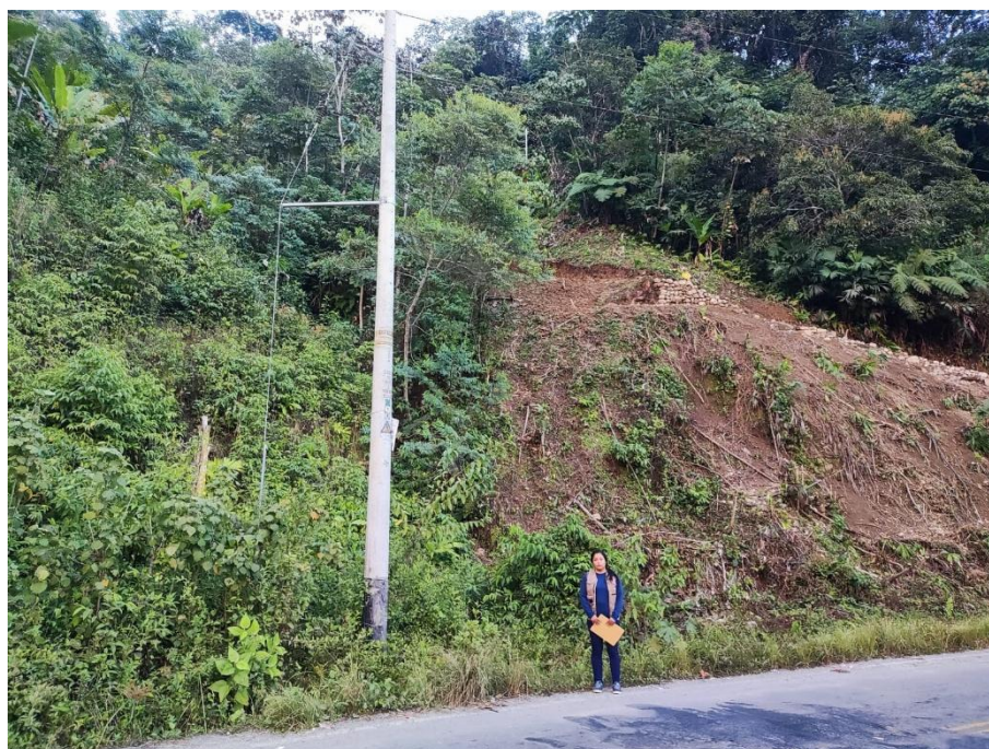
Fotografía 2 Deslizamientos de suelos por lluvias
