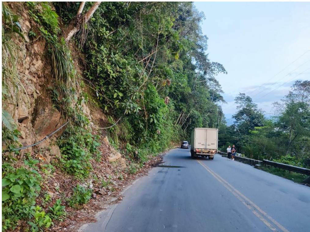
Fotografía 6 Deslizamientos de suelo por lluvias en carretera
