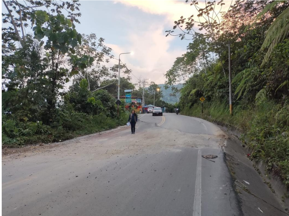
Fotografía 5 Deslizamiento y hundimiento de suelos en carretera
