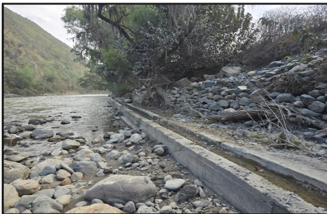
En la vista fotográfica se muestra el canal de riego existente colapsado con sedimentos que no deja entrar el flujo
