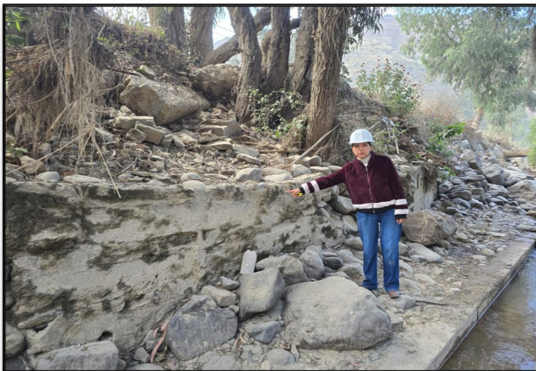
En la vista fotográfica se observa el ahuellamiento generado por máximas avenidas del cauce del rio
