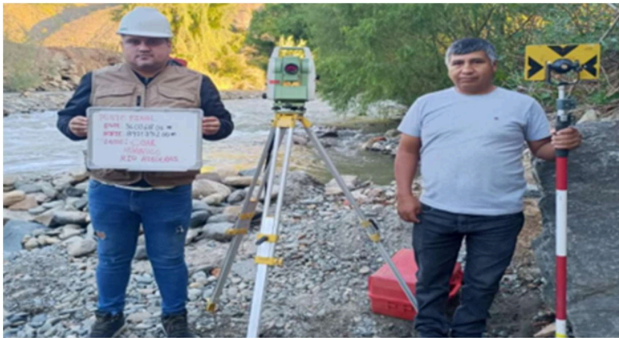
En la imagen se puede observar el inicio del levantamiento topográfico del área de la cuenca del río higueras
