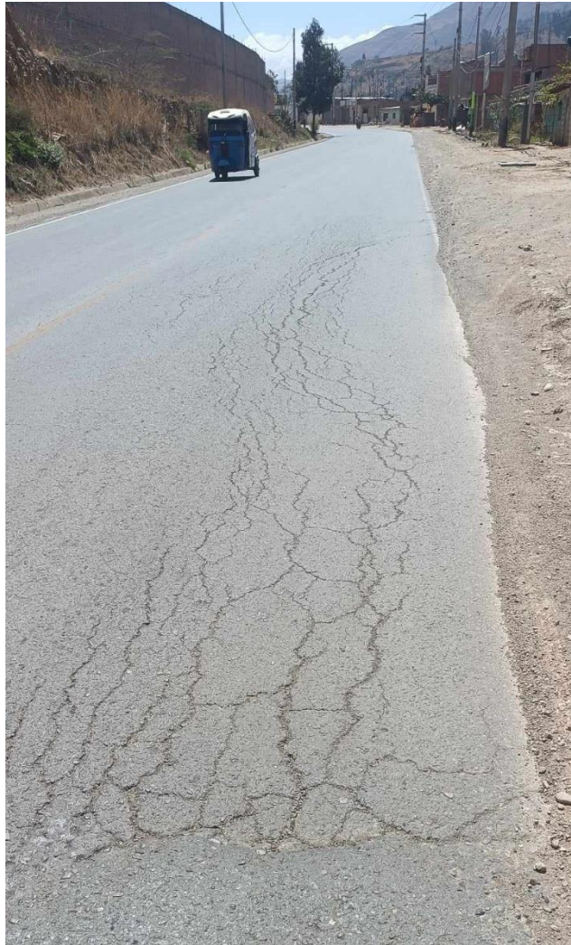
Fotografía 8: Deterioro superficial del pavimento por fisuración combinada
