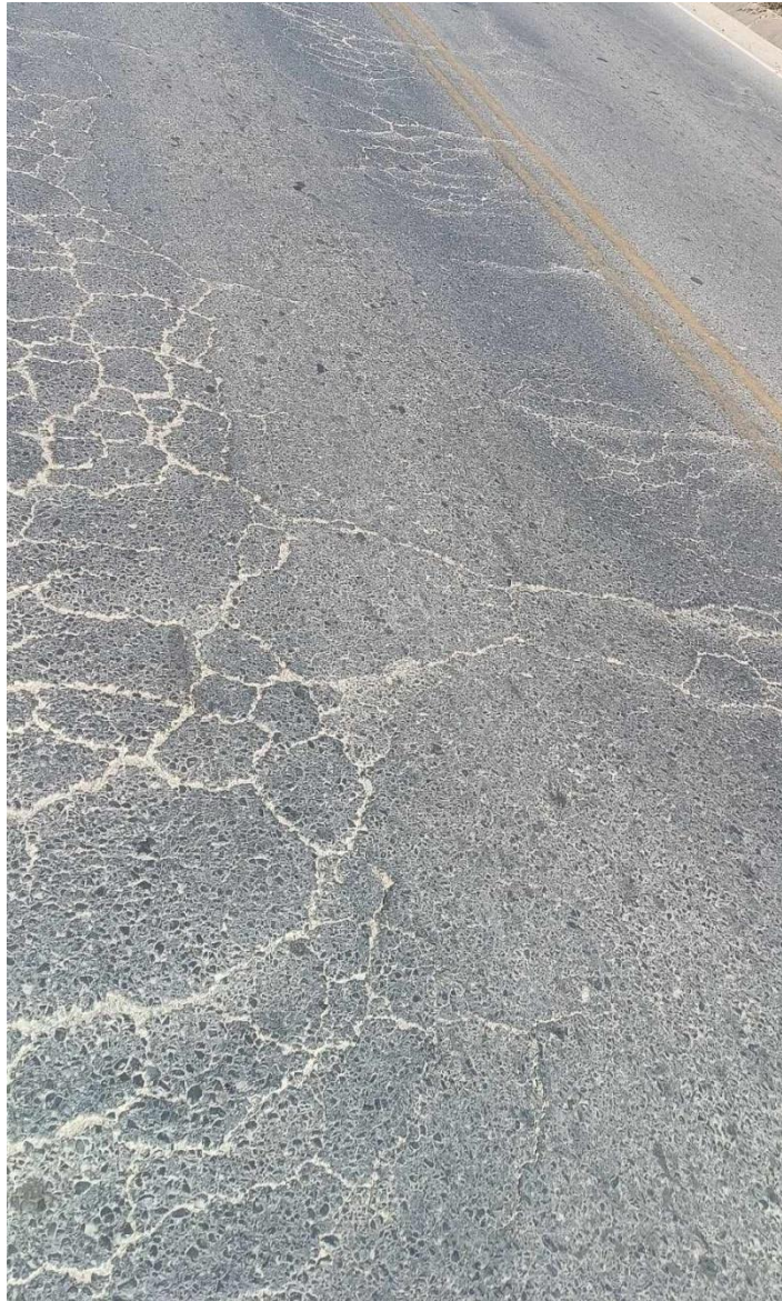
Fotografía 7: Fisuras transversales y longitudinales con piel de cocodrilo
