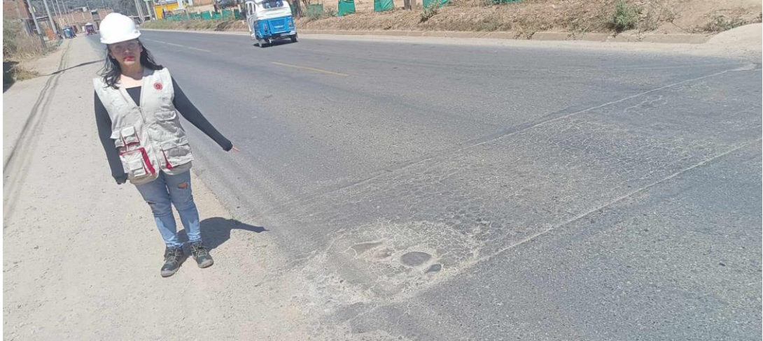
Fotografía 13: Baches y fisuración en superficie de rodadura
