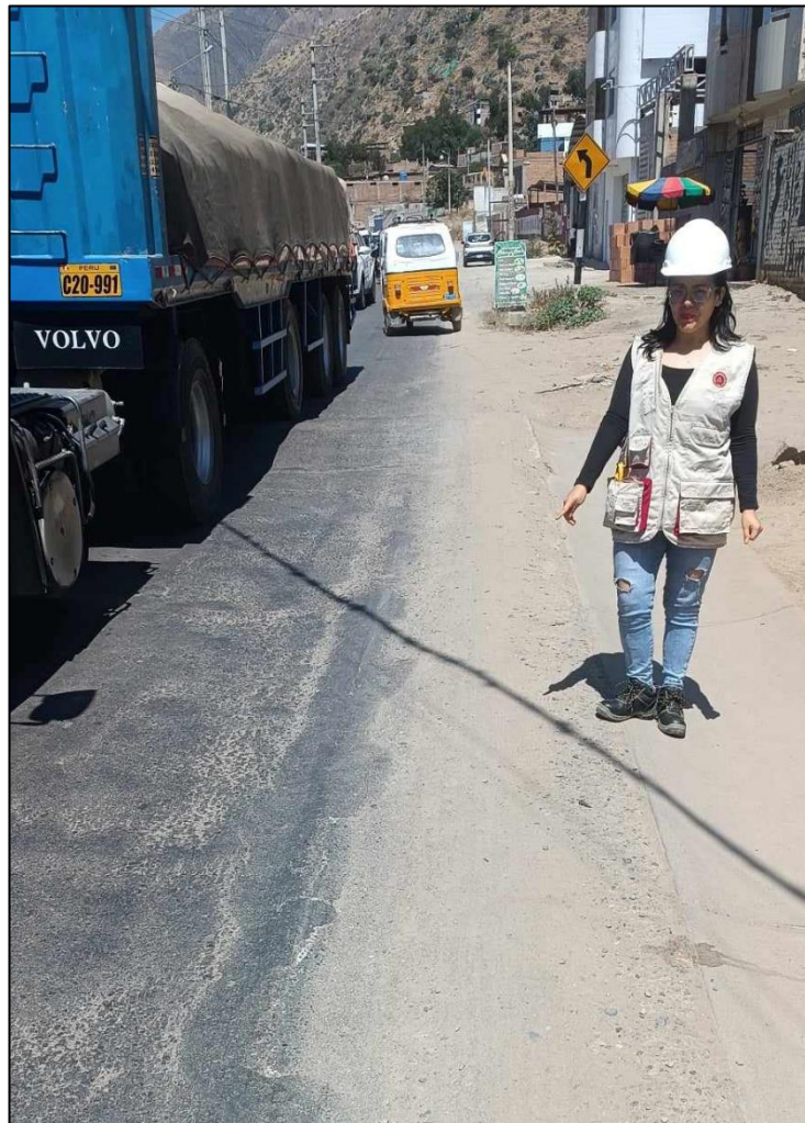
Fotografía 2: Pulimento de agregados y fisuras en calzada por tránsito vehicular
