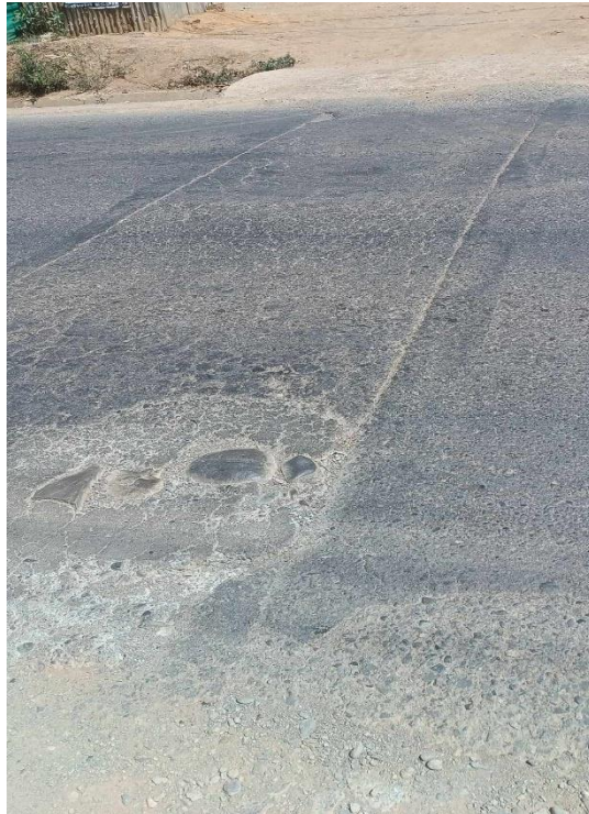
Fotografía 14: Baches y fisuración en superficie de rodadura
