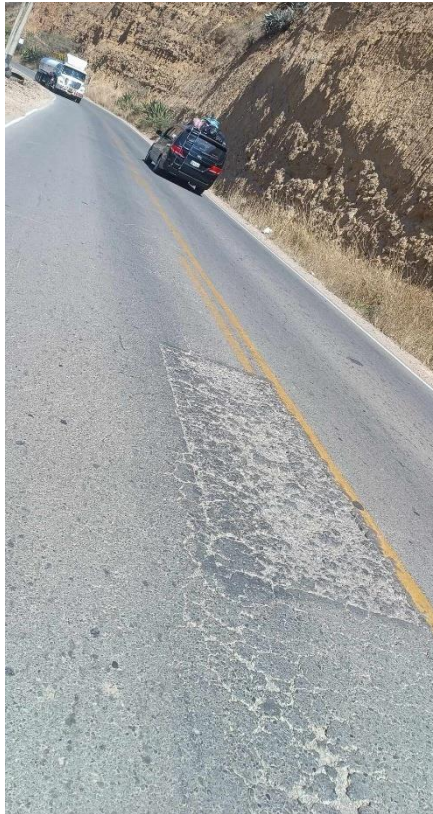
Fotografía 10: Pulimento de agregados y fisuración en tramo recto de la vía
