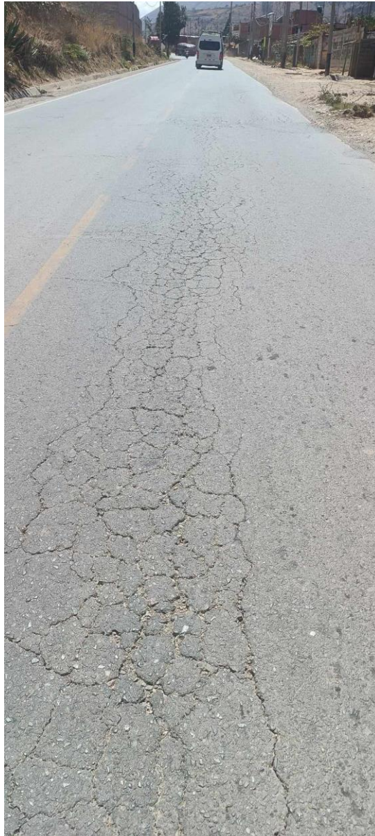
Fotografía 6: Pulimento de agregados y fisuración múltiple en la superficie de rodadura
