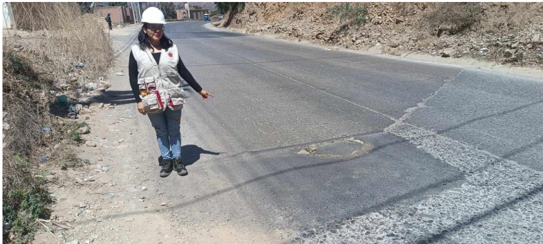
Fotografía 12: Pulimento severo de agregados en pavimento asfáltico
