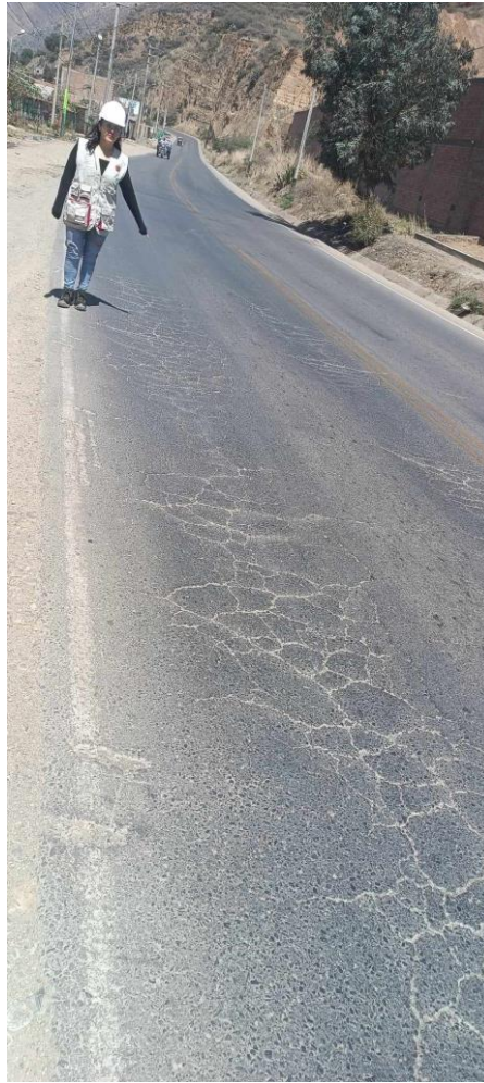
Fotografía 16: Fisuración tipo piel de cocodrilo en tramo de alto tránsito
