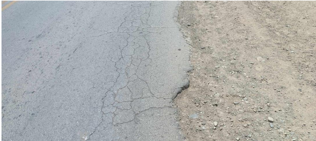
Fotografía 11: Fisuración longitudinal en borde de calzada
