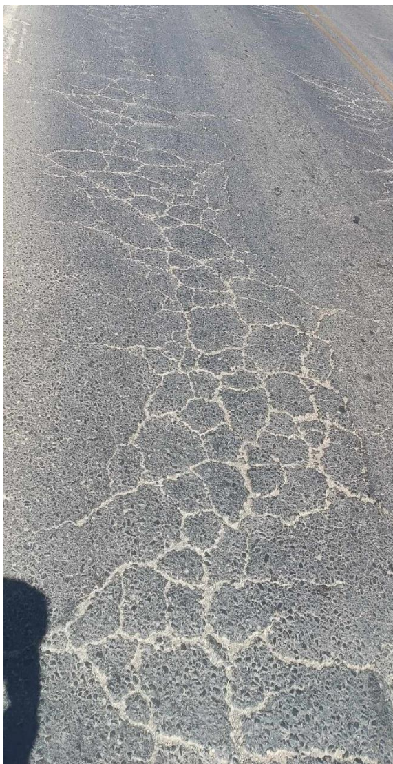
Fotografía 5: Fisuración tipo piel de cocodrilo en pavimento asfáltico
