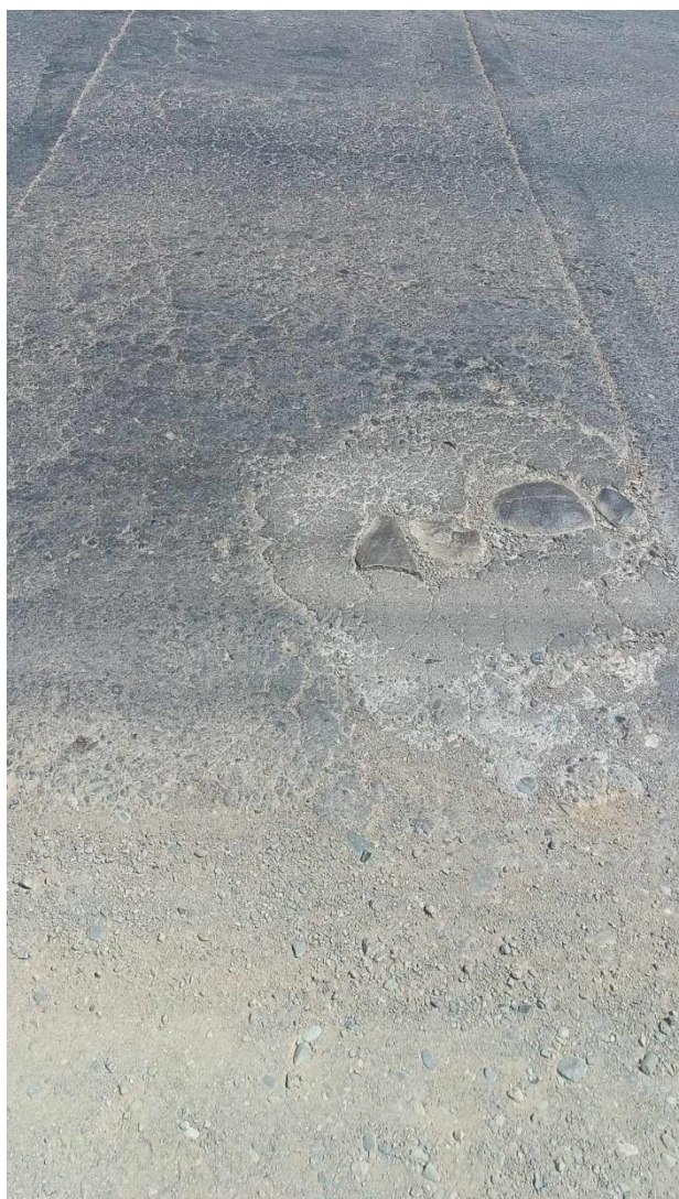
Fotografía 9: Fisuración y presencia de baches en pavimento asfáltico
