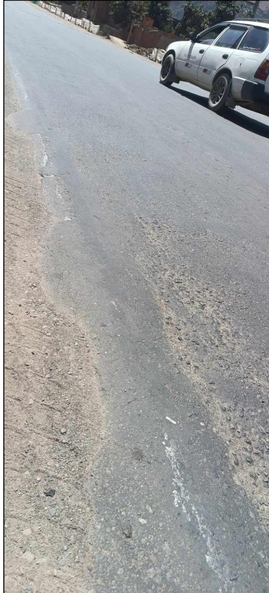
Fotografía 1: Pulimento de agregados y ahuellamiento superficial en pavimento asfáltico
