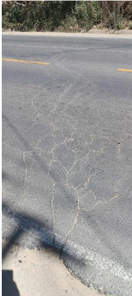
Fotografía 15: Baches y fisuración en superficie de rodadura
