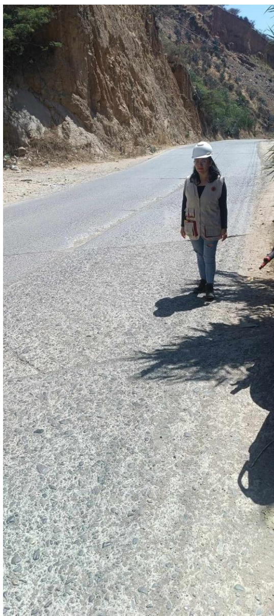
Fotografía 4: Pulimento de agregados y fisuras asociadas a alto tránsito vehicular
