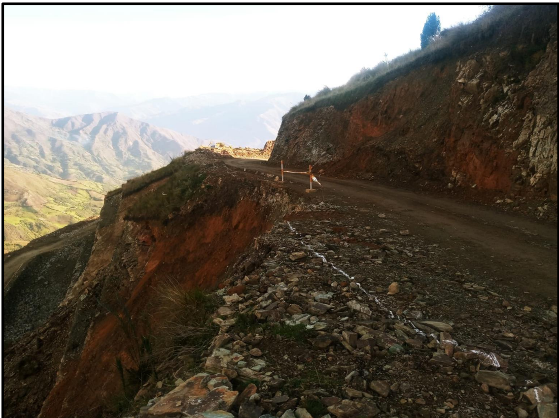
DESLIZAMIENTO DE TALUD INFERIOR EN LA ZONA DE ESTUDIO
