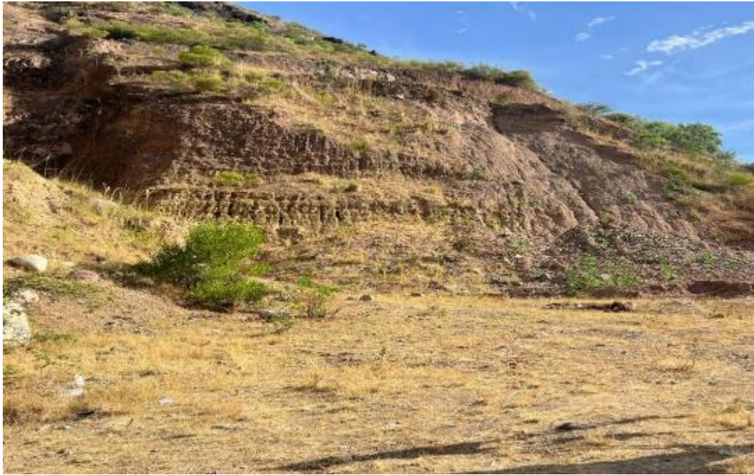
Vista panorámica del talud en el kilómetro 352 de la carretera Cerro de Pasco – Huánuco.
