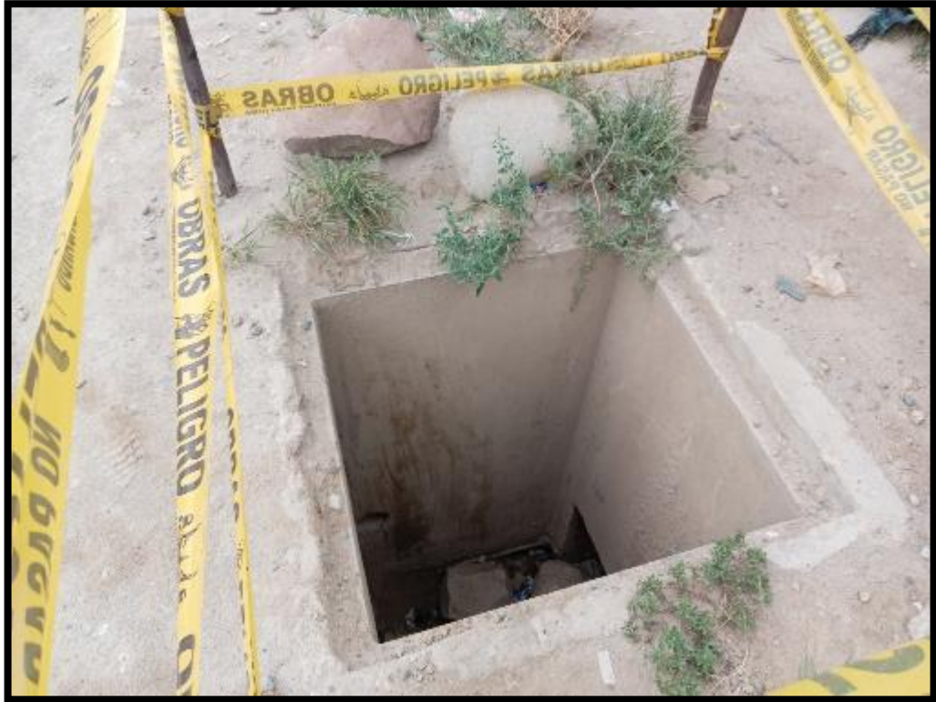
Se aprecia en la fotografía la obstrucción de las Cajas de inspección de drenaje de aguas de lluvia existentes.
