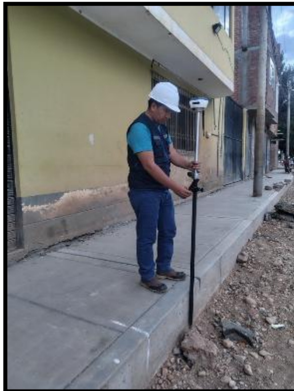
Levantamiento topográfico de las veredas y su desnivel para, el replanteo de cunetas y el pavimento rígido.
