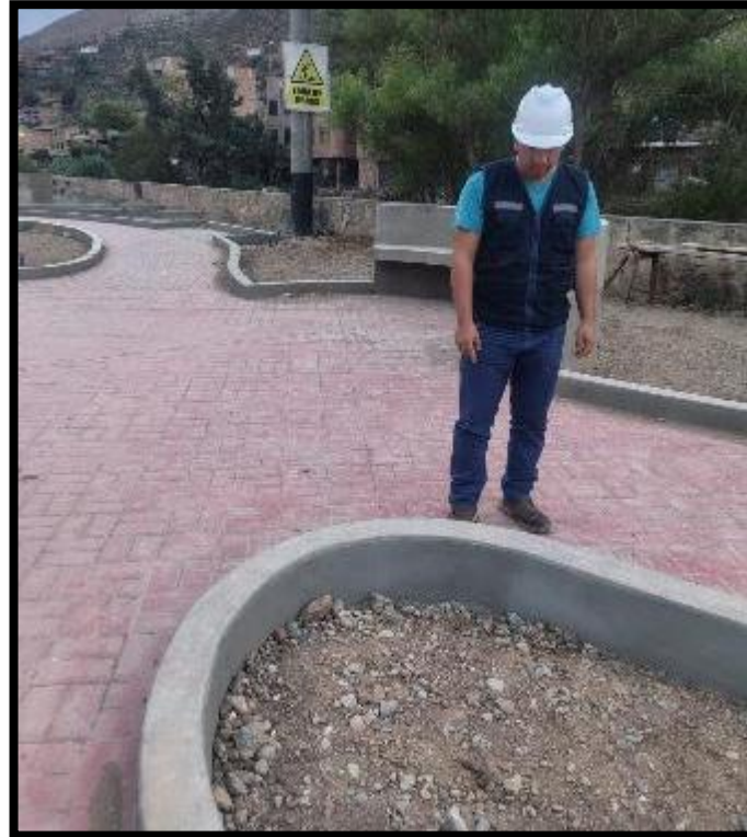
Sardineles semicirculares recién desencofrados conformes de acuerdo al diseño planteado en el proyecto.
