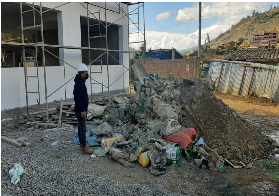
El inadecuado depósito de los residuos de la construcción, durante el periodo de ejecución de la obra.
