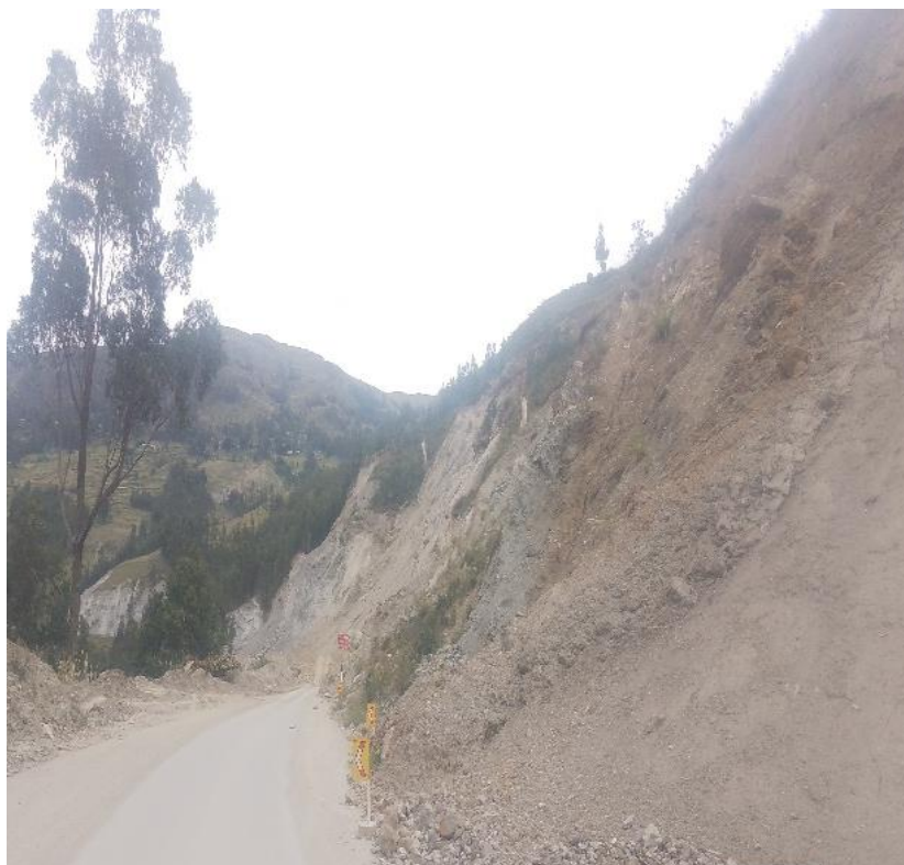
Detalle del punto critico con mayor inestabilidad (deslizamiento activo) del tramo II de Huánuco a La union.
