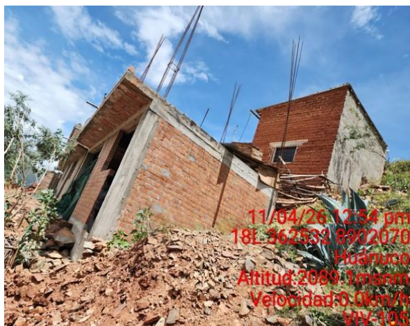
Vivienda de ladrillo inacabada con cimentación expuesta a la acción del agua y mortero de baja calidad.
