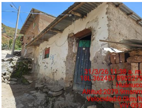
Vivienda de tapial con revestimiento, presenta fisuración y deterioro del acabado, con humedad en la base.
