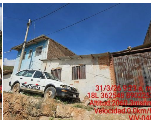
Vivienda de tapial, presenta ubicación en talud y vulnerabilidad por inestabilidad del terreno.
