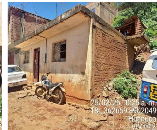
Vivienda de ladrillo artesanal con acero de refuerzo expuesto y base estructural deteriorada.
