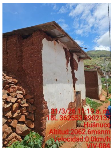
Vivienda de adobe, presenta pérdida de material y deterioro severo del muro.
