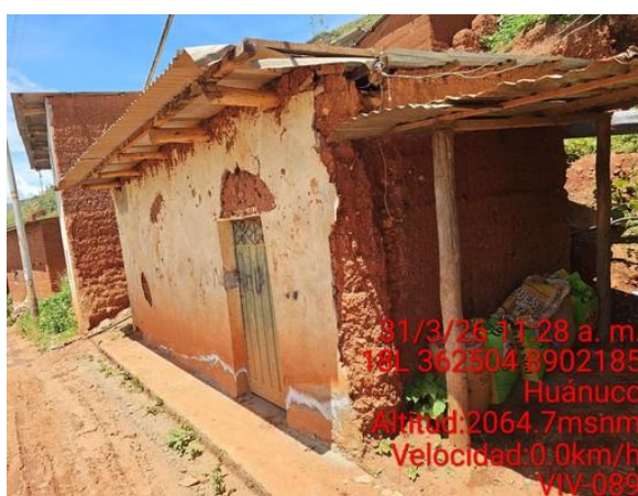
Vivienda de tapial con revestimiento, presenta deterioro del tarrajeo y afectación por humedad.
