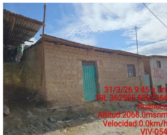
Vivienda de adobe con humedad en la cimentación por ausencia de drenaje pluvial y posible empozamiento de agua de lluvia.
