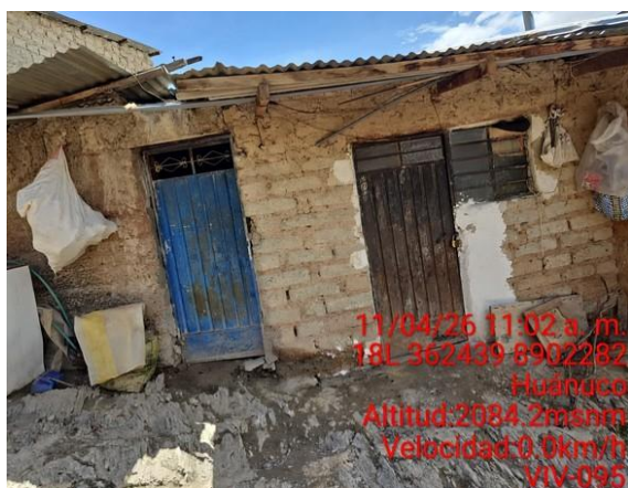
Vivienda de adobe, presenta deterioro del muro y erosión, con exposición a humedad.
