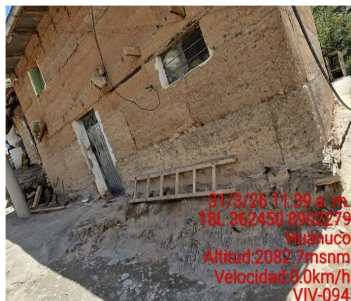
Vivienda de tapial, presenta desgaste superficial y fisuras, con afectación por humedad.
