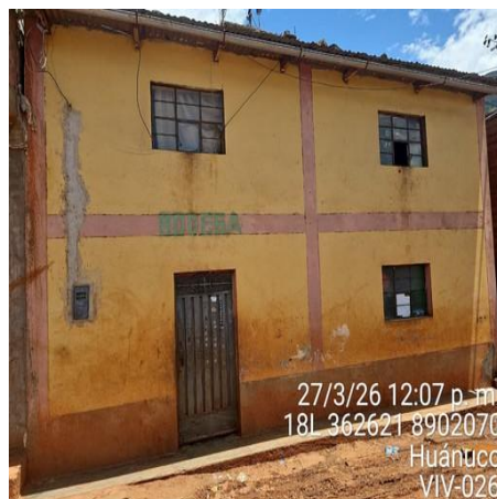
Vivienda con fisuración moderada, deficiente drenaje pluvial y deterioro general.
