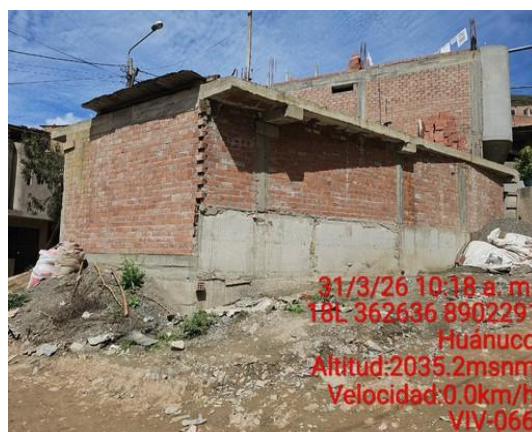
Vivienda de albañilería de ladrillo, con acabado deficiente, presenta cimentación deteriorada con presencia de cangrejas y ausencia de drenaje
