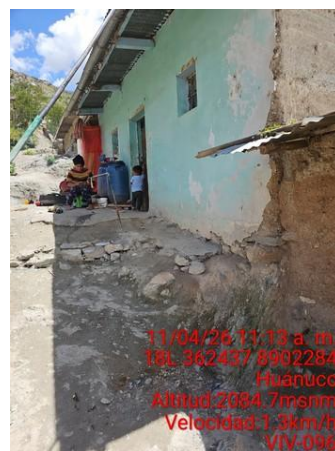
Vivienda de tapial, presenta fisuración y desgaste del material, con deficiente drenaje en el entorno.
