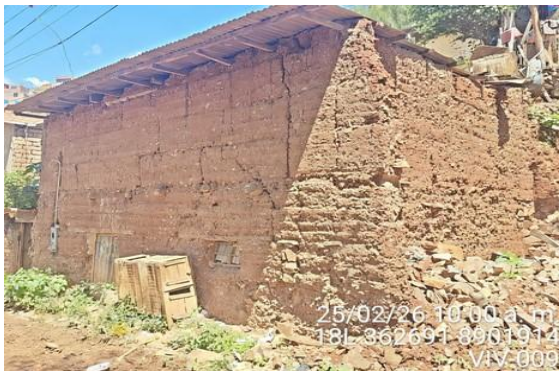
Vivienda de tapial con deterioro de muros y fisuración debido a filtración pluvial por techo de calamina dañado.
