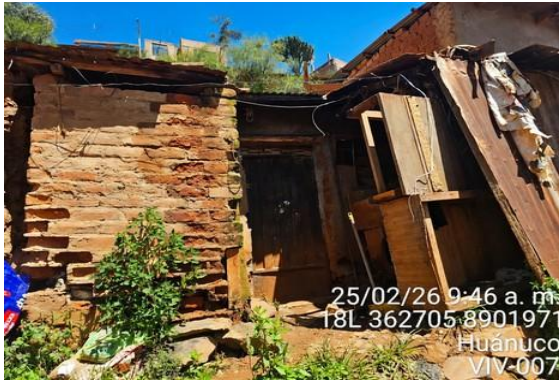
Vivienda de ladrillo artesanal con deterioro por lluvia directa y base dañada por drenaje deficiente.
