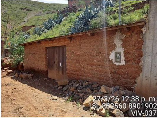
Vivienda de adobe con erosión superficial y desprendimiento de revestimiento, presenta humedad en la base.
