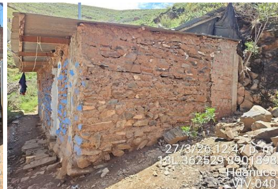
Vivienda de piedra y barro con irregularidad en muros y falta de confinamiento, presenta riesgo estructural.
