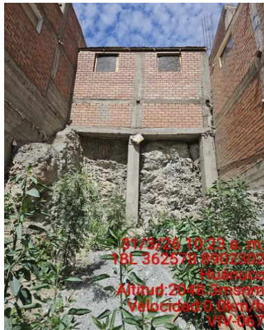
Vivienda de albañilería de ladrillo, presenta cimentación expuesta y riesgo por socavación del talud.
