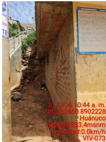
Vivienda de albañilería de ladrillo, presenta erosión del talud colindante y riesgo por inestabilidad del terreno.
