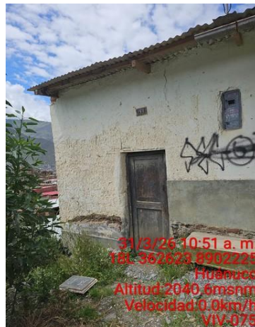
Vivienda de adobe, presenta fisuración en muros y humedad ascendente en la base.
