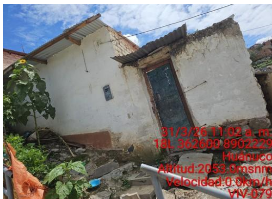
Vivienda de adobe con revestimiento, presenta fisuración y deterioro del tarrajeo, con humedad en la base.
