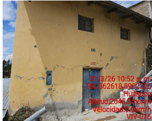
Vivienda de adobe con revestimiento, presenta fisuras y desprendimiento de acabado, con afectación por humedad.
