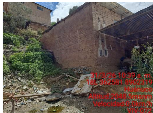
Vivienda de tapial/adobe, presenta humedad en la base y deficiente drenaje en el entorno.
