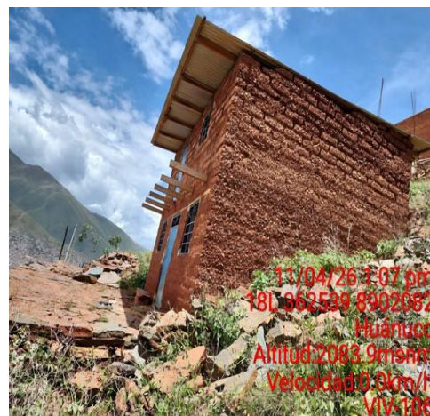
Vivienda de adobe en mal estado, con unión de adobes deteriorada y emplazamiento en ladera con riesgo de deslizamiento.
