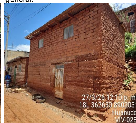
Vivienda heterogénea (tapial y adobe) con muros deteriorados por exposición directa a la lluvia y ausencia de drenaje pluvial.
