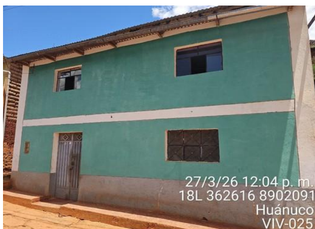
Vivienda con fisuración superficial y ausencia de drenaje pluvial.
