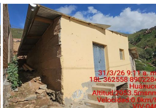
Vivienda de tapial con revestimiento, presenta desprendimiento del tarrajeo y humedad en la base.
