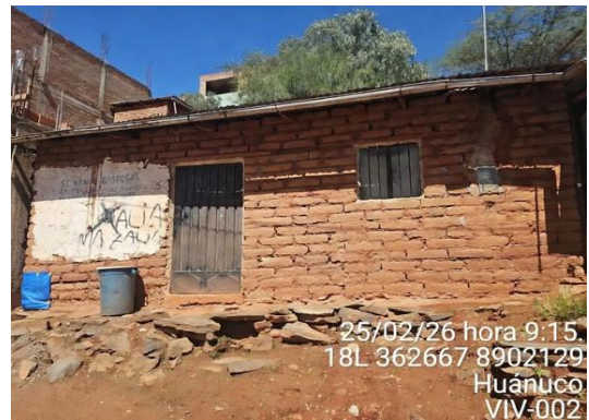
Vivienda de adobe con fisuración estructural y deterioro del sobrecimiento, consecuencia de asentamiento diferencial.
