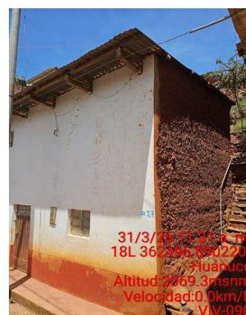
Vivienda de tapial, presenta fisuras y desgaste superficial, con humedad en la base.
