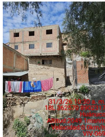
Vivienda de sistema mixto (adobe y tapial), presenta irregularidad estructural y vulnerabilidad por ubicación en pendiente.
