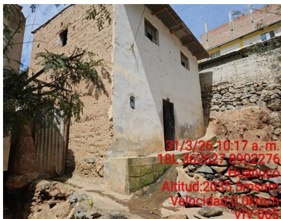
Vivienda en pendiente, con cimentación expuesta y sin drenaje pluvial, presenta exposición a humedad.
