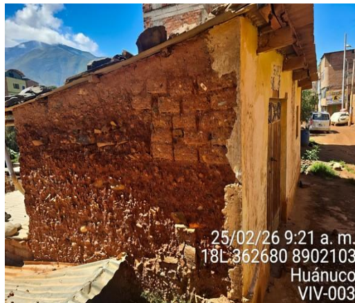
Edificación de adobe con degradación del material por acción de humedad pluvial.
