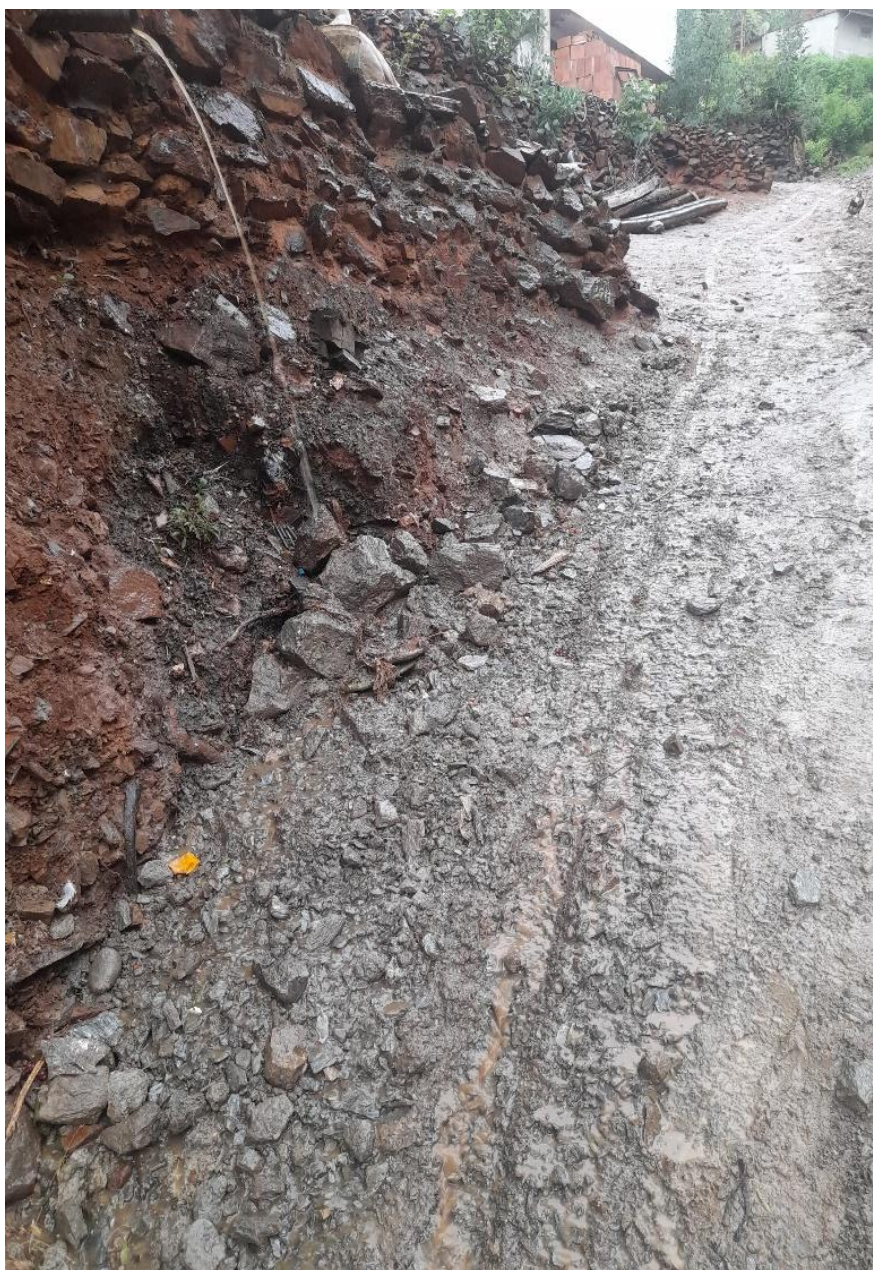
Marzo 2025: camino erosionado con presencia de material suelto y muro de contención precario en el AA. HH Aparicio pomares, Huánuco (2025).
