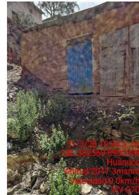
Vivienda de adobe, presenta deterioro de muros y riesgo por inestabilidad del terreno.
