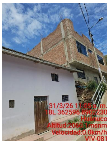
Vivienda de tapial con elementos de concreto, presenta irregularidad estructural y ubicación en pendiente.
