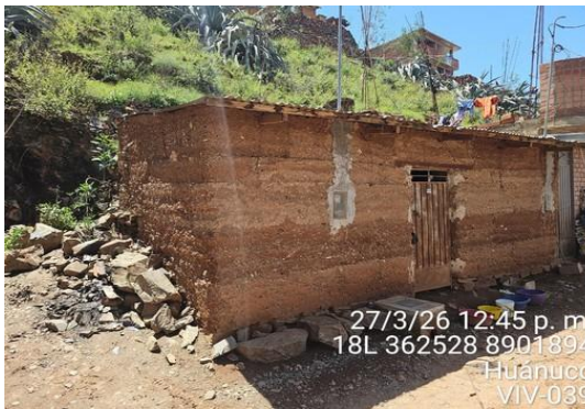
Vivienda de tapial con fisuras y desgaste por intemperie, presenta acumulación de humedad en la cimentación.
