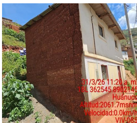
Vivienda de tapial, presenta humedad en la base y deficiente drenaje en el entorno.
