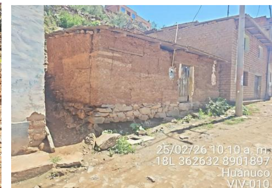
Vivienda de tapial con muros y base deteriorados, con fisuración por exposición directa a la lluvia.
