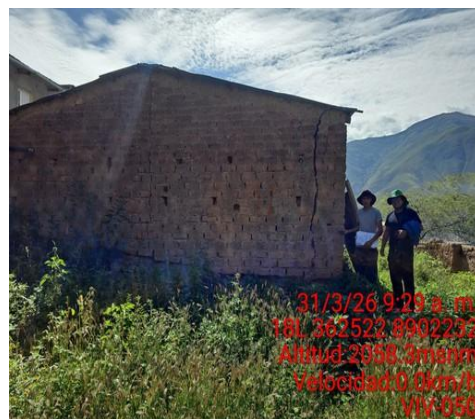
Vivienda a punto de colapso, con fisura extrema, cimentación y muros inferiores afectados por humedad y ausencia de drenaje pluvial.
