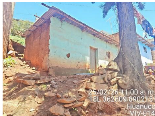
Vivienda con rajaduras y desgaste en paramentos, y base mal ubicada
