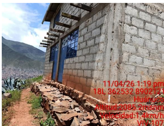
Vivienda de bloques de concreto con mortero deficiente, cimentación expuesta sobre piedras y ausencia de drenaje pluvial, con humedad por escorrentía.
