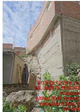
Vivienda de albañilería de ladrillo con elementos de concreto, presenta deficiencias en la contención del terreno y riesgo por inestabilidad lateral.
