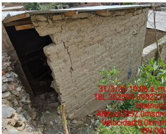
Vivienda de adobe en estado crítico, presenta fisuración severa y riesgo de colapso por humedad.
