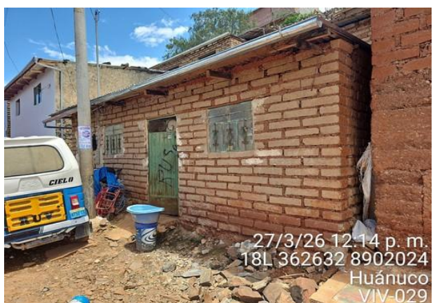
Vivienda de adobe con desagüe expuesto, carencia de sistema de drenaje pluvial y cimentación afectada por humedad capilar.
