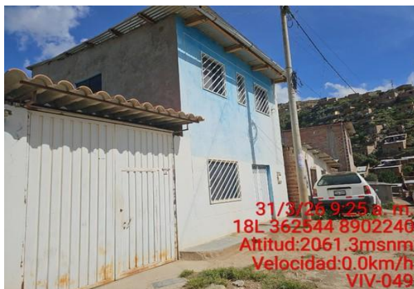
Vivienda mal ubicada sobre desmonte, con cimentación inestable y fisuras leves en la fachada.
