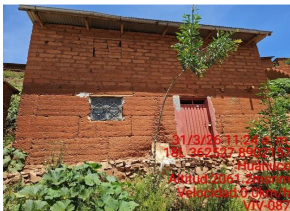
Vivienda de adobe/tapial, presenta fisuración y erosión superficial, con humedad en la base.
