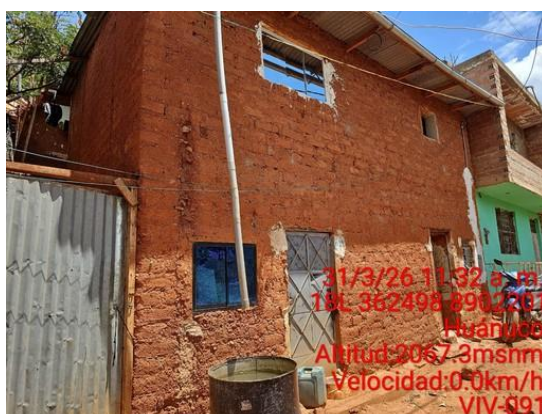
Vivienda de adobe, presenta deficiente acabado y exposición a humedad en muros.
