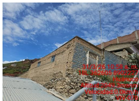
Vivienda de adobe, presenta deficiente confinamiento y riesgo estructural por inestabilidad del terreno.
