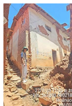
inspeccionando y midiendo la grieta en la vivienda de adobe, la cual presenta daños críticos en paramentos y muros, sin drenaje y con desagüe expuesto
