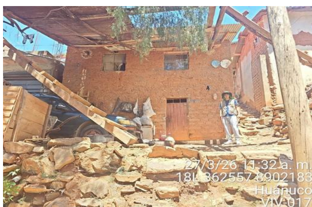
realizando la inspección para identificar los problemas de la vivienda de adobe, la cual presenta deterioro por lluvia directa y drenaje deficiente
