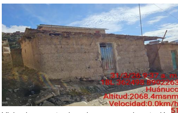
Vivienda a punto de colapsar, con cimentación comprometida, fisuras en muros, ausencia de drenaje pluvial y escorrentía de agua sobre la puerta que agrava el daño durante lluvias.
