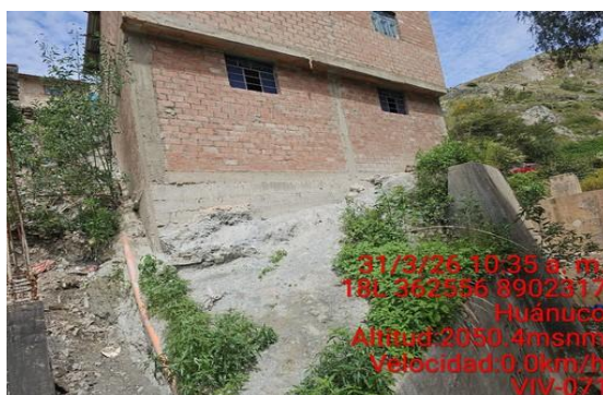
Vivienda de albañilería de ladrillo, presenta cimentación expuesta y riesgo por erosión del suelo.
