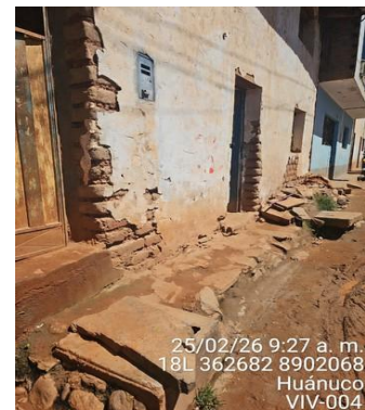
Edificación de adobe con degradación por humedad pluvial y drenaje deficiente hacia la base.
