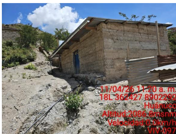
Vivienda de tapial, con inadecuada ubicación en quebrada, presenta cimentación expuesta y exposición a humedad.
