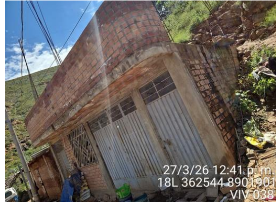
Vivienda de albañilería de ladrillo con estructura de concreto, presenta deficiencias constructivas y exposición a humedad lateral.
