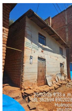
Vivienda de adobe con daño por agua de lluvia, desagüe inadecuado y rajaduras en el lateral.
