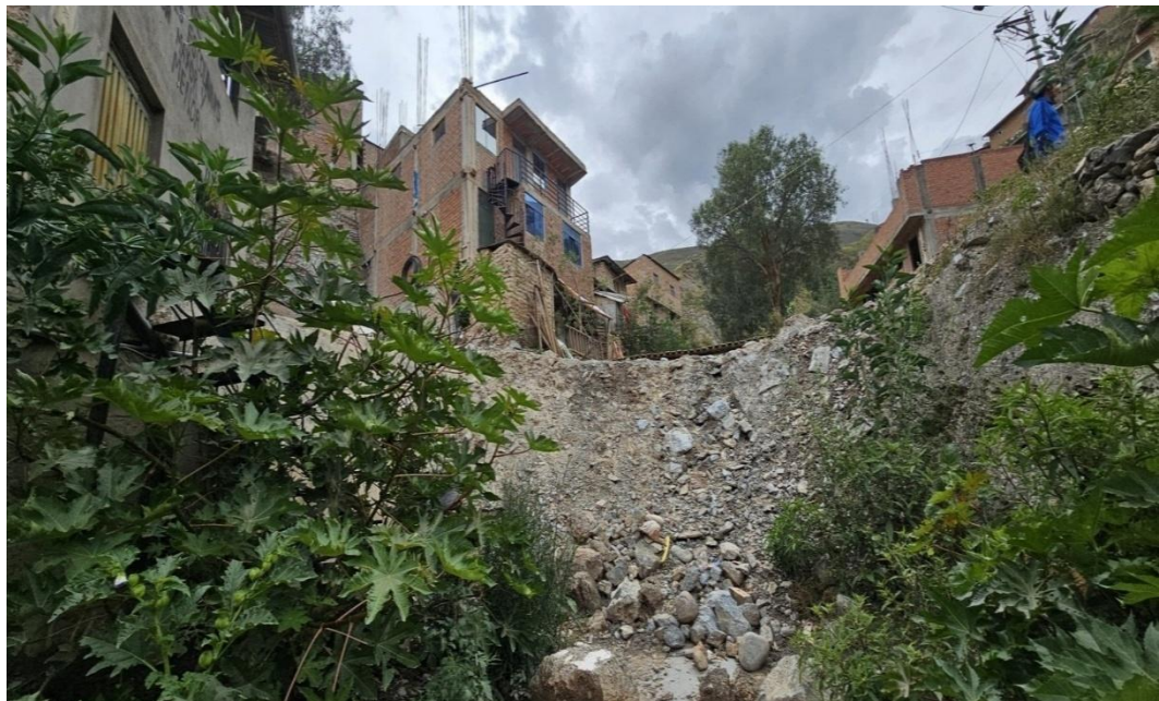
Febrero 2025: desprendimiento de masa con acumulacion de material suelto en zona urbana del AA.HH aparicio pomares, Huanuco (2025).
