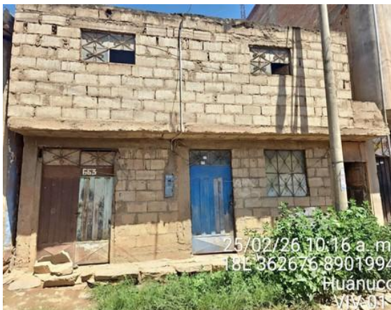
Vivienda de bloques de concreto con mortero deficiente, ausencia de vigas estructurales y presencia de cangrejeras.
