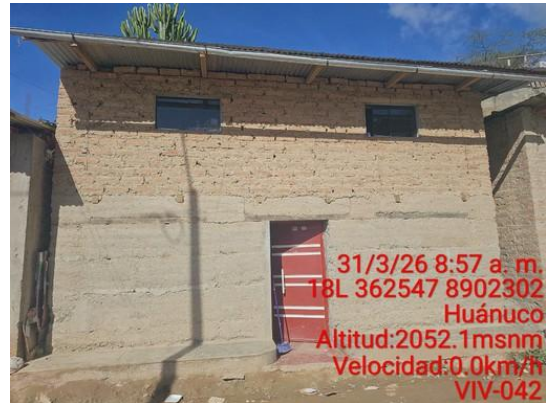
Vivienda de sistema mixto (adobe y tapial) con zócalo deteriorado, presenta afectación por humedad ascendente.
