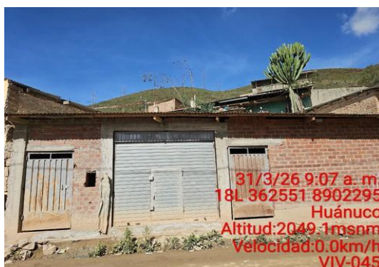
Vivienda de albañilería de ladrillo con deficiente acabado, presenta vulnerabilidad estructural.
