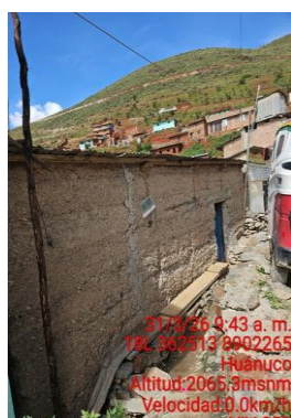
Vivienda mal ubicada en ladera, con fisuras en muros, acumulación de humedad en la cimentación y ausencia de drenaje pluvial.
