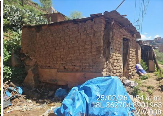
Vivienda de adobe en riesgo de colapso con degradación severa de paramento y cimentación por acción pluvial directa.
