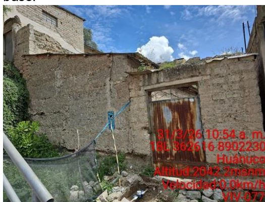
Vivienda de adobe en estado crítico, presenta colapso parcial y pérdida de estabilidad estructural.
