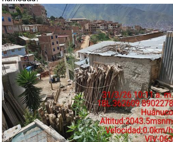
Vivienda de tapial con suelo arcilloso, sin drenaje; presenta humedad ascendente en la base y deterioro del muro.
