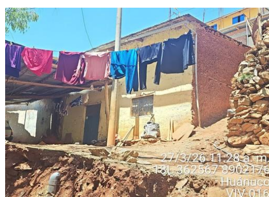
Vivienda de tapial con deterioro por acción pluvial y deficiente evacuación de aguas
