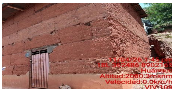
Vivienda de tapial en estado crítico, con fisuras y deterioro de muros por infiltración de lluvia, humedad en la cimentación y falta de drenaje pluvial.
