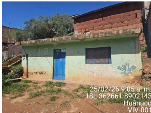
Muro artesanal con cocción deficiente, presenta cangrejas y deterioro superficial.
