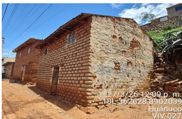
Vivienda de adobe con cimentación expuesta, sin drenaje y muros deteriorados por lluvia, recubiertos con mortero deficiente.
