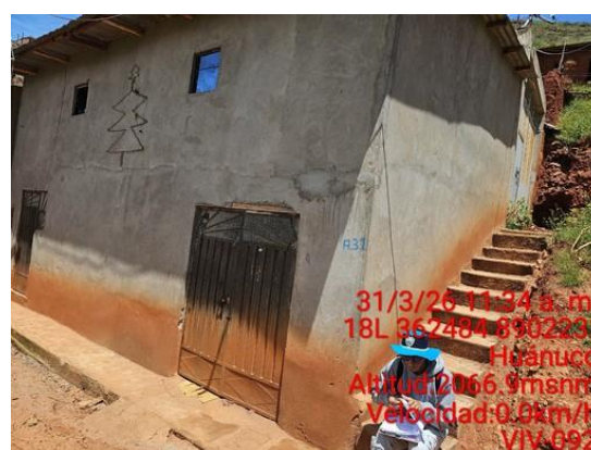
Vivienda de adobe con revestimiento, presenta fisuración del muro y humedad ascendente en la base.
