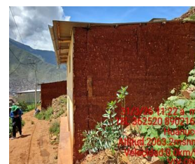
Vivienda de tapial con rajaduras.
