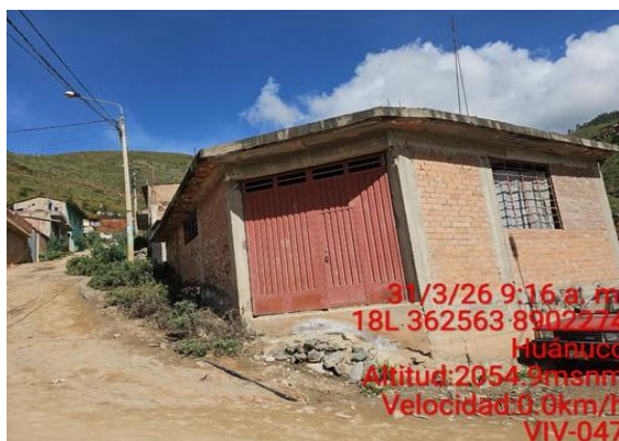
Vivienda de albañilería confinada (ladrillo y concreto), presenta irregularidades constructivas y riesgo estructural.
