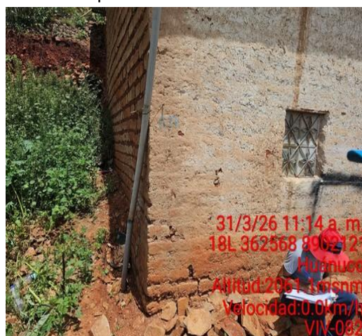
Vivienda de adobe, presenta erosión en la base y exposición a humedad.
