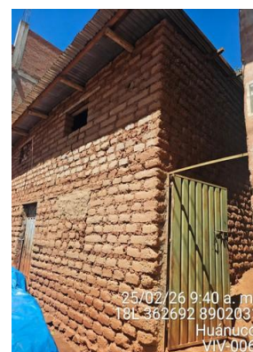
Vivienda de adobe con deterioro por lluvia directa y drenaje deficiente.
