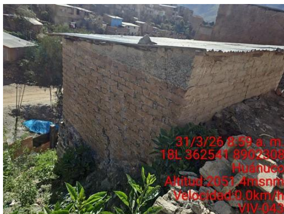
Vivienda de adobe con erosión y desprendimiento de revestimiento, presenta humedad en la base.
