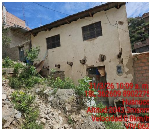
Vivienda de tapial con fisuración leve, ubicada en quebrada con desmonte, presenta humedad en la base.
