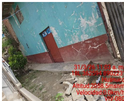
Vivienda de adobe con revestimiento, presenta desprendimiento de acabado y fisuras superficiales.
