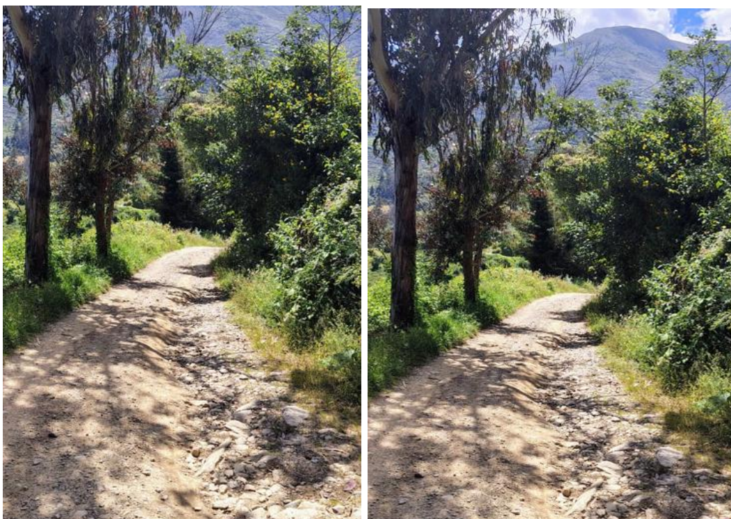
Reconocimiento de campo realizado para identificar problemas de mantenimiento vial que influyen en la transitabilidad de la ruta.
