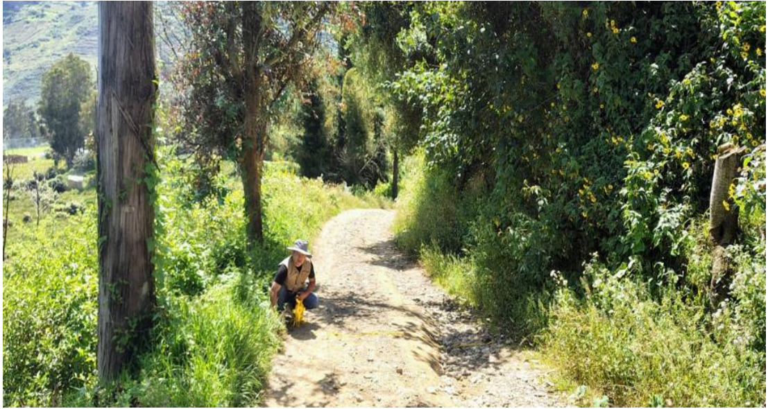
Observación directa de las condiciones de la carretera durante el trabajo de campo, apreciándose deficiencias en la conservación de la infraestructura vial.
