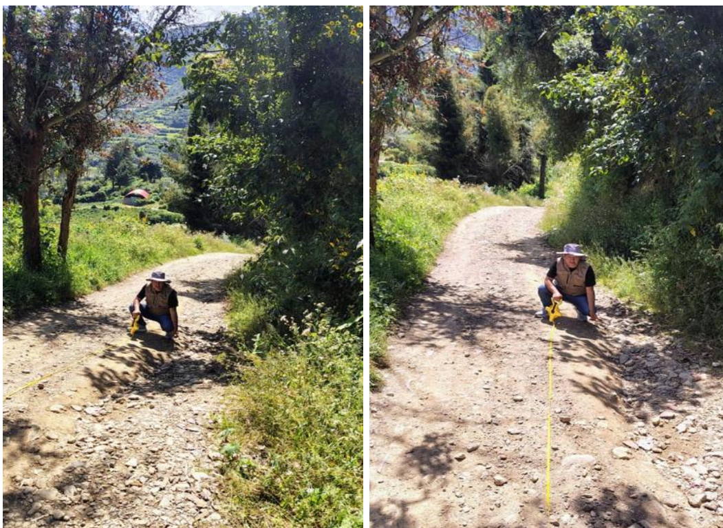
Evaluación in situ del estado de conservación de la carretera, evidenciándose la presencia de deterioros que afectan las condiciones de transitabilidad.
