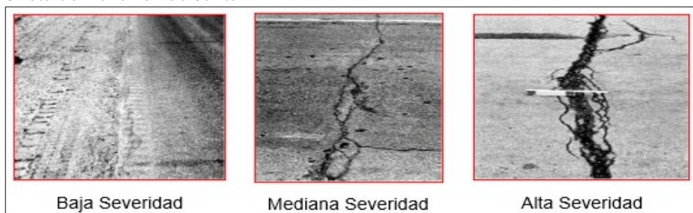
Figura 12 Grieta de Reflexión de Junta
