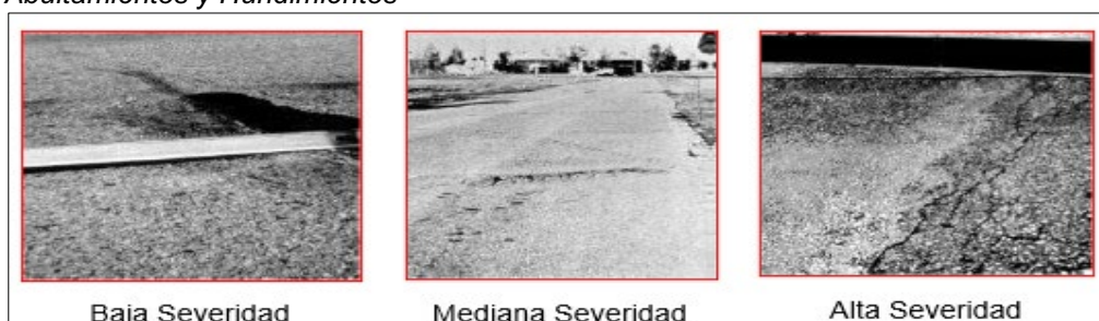
Figura 8 Abultamientos y Hundimientos
