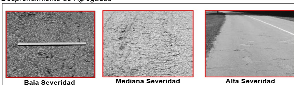
Figura 23 Desprendimiento de Agregados
