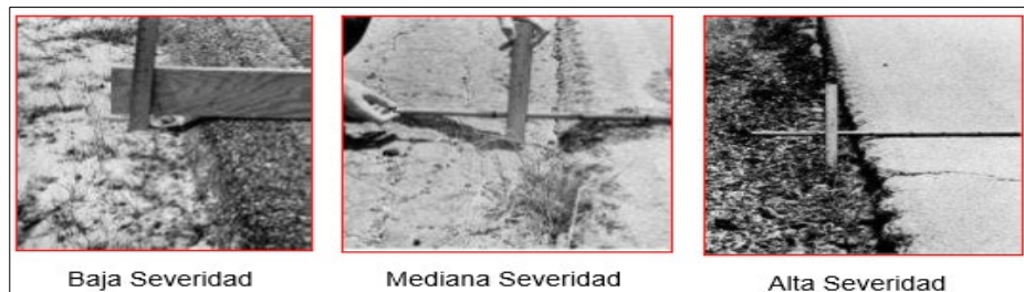
Figura 13 Desnivel Carril / Berma
