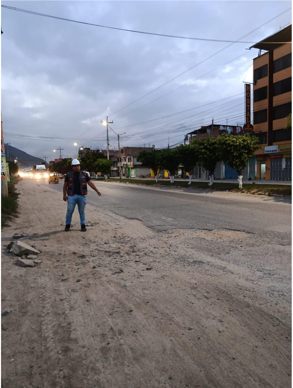
Foto de baches en el tramo del área en estudio.
