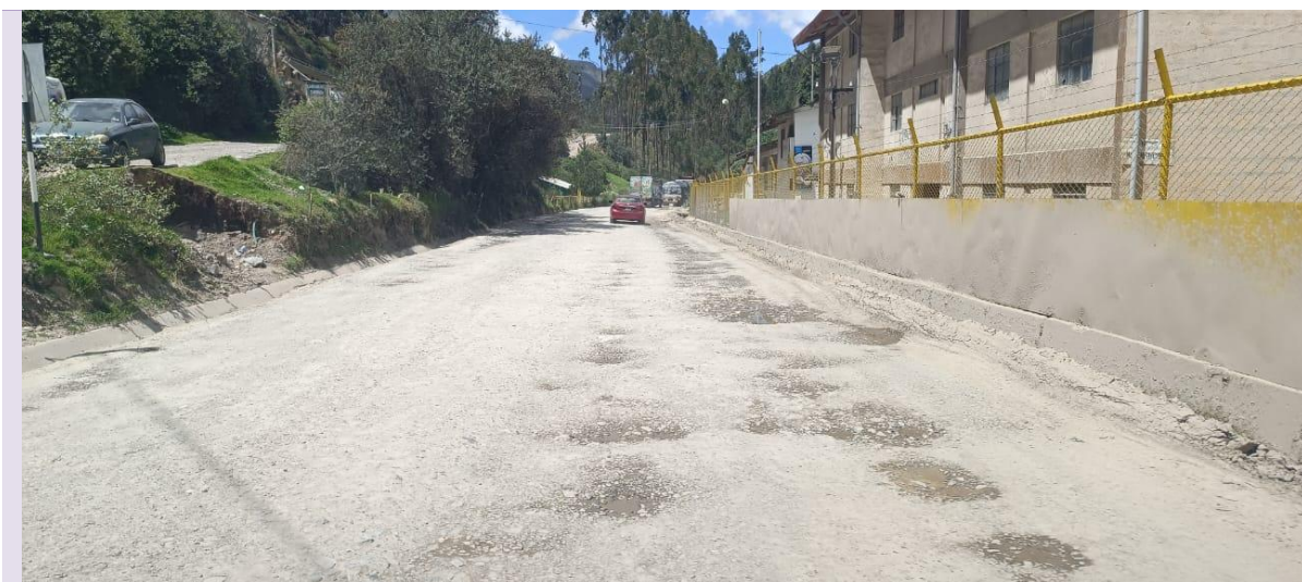
RUTA CERRO DE PASCO – HUÁNUCO DONDE EVIDENCIAMOS LAS DEFICIENCIAS DE LA CARRETERA
