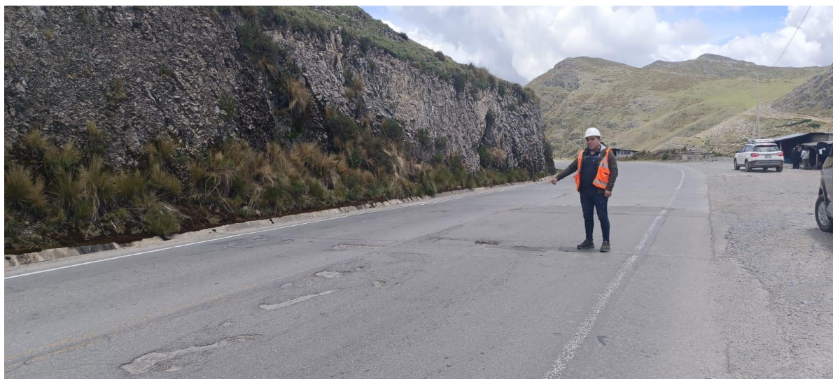
RUTA CERRO DE PASCO – HUÁNUCO VISIBILIZANDO LAS FALLAS EN LA CARRETERA
