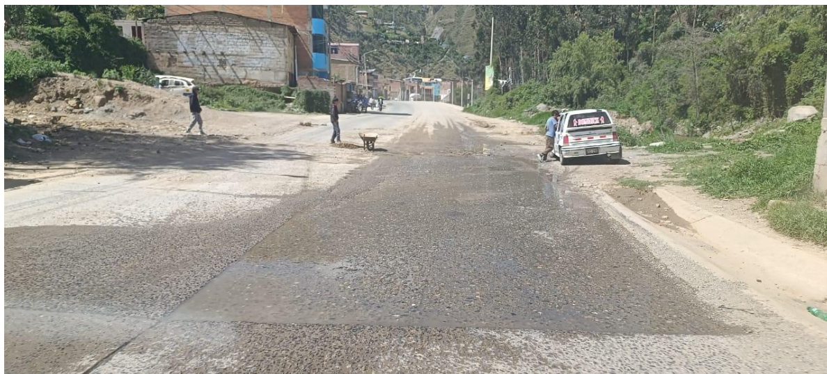
RUTA CERRO DE PASCO – HUÁNUCO SE VISIBILIZA EL MAL ESTADO DE LA VÍA EN ESTE TRAMO
