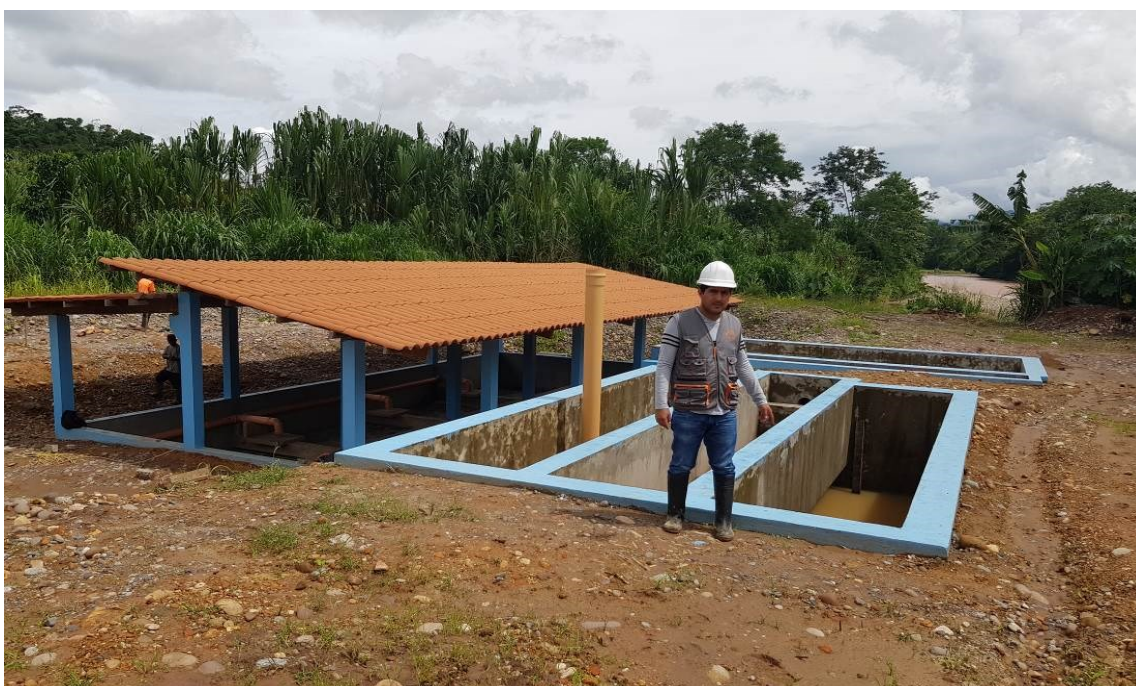
En la vista fotográfica se observa la PTAR de Pumahuasi culminado
