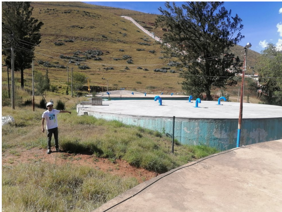
Los reservorios son de forma circular, de concreto armado y con diversos volúmenes de capacidad.
