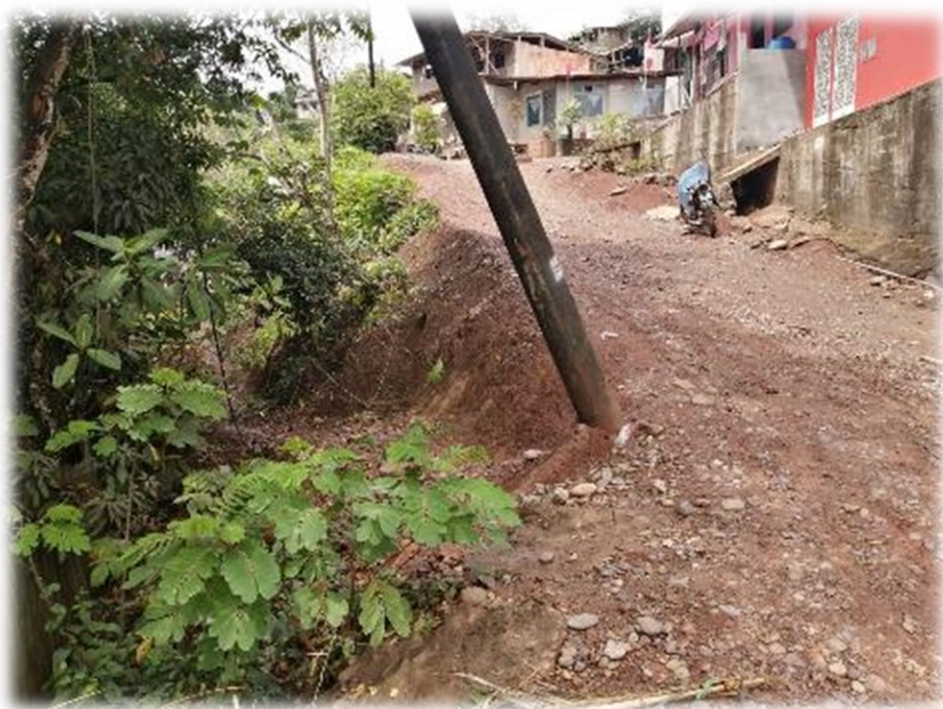
Vista de uno de los postes del sistema eléctrico en peligro de colapso total, que requiere su reubicación
