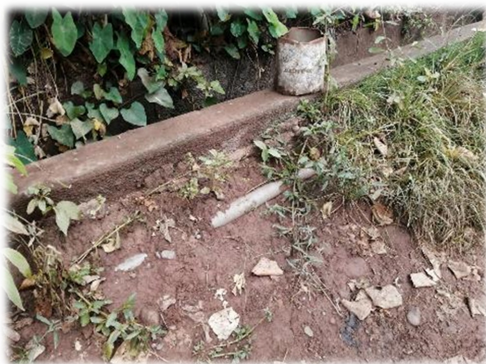
Vista dela red matriz del sistema de agua potable que se encuentra superficial y requiere el cambio y profundidad de la tubería.
