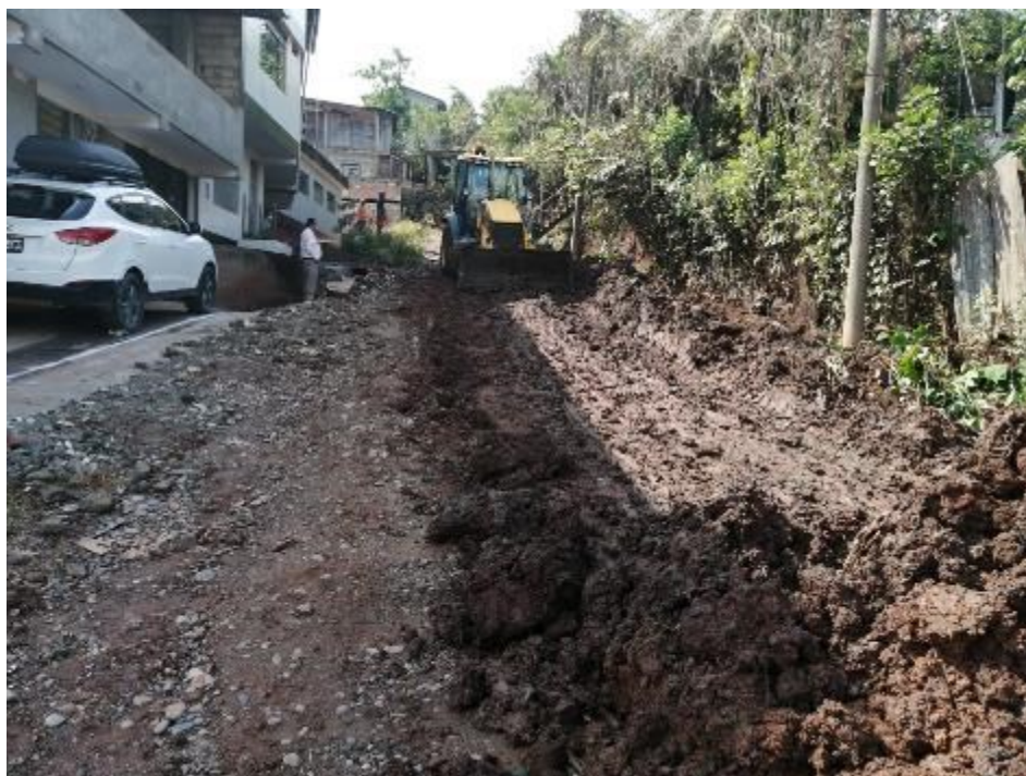
Vista del canal que utilizan como desagüe y a aturado el suelo y se requiere su eliminación y cambio de material.
