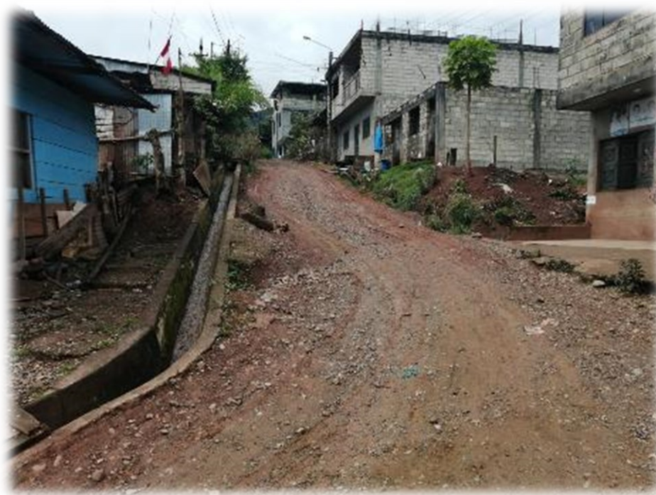
Vista de lado el canal trapezoidal existente de concreto que se encuentra deteriorado y que es indispensable su demolición para continuar con la ejecución de la obra
