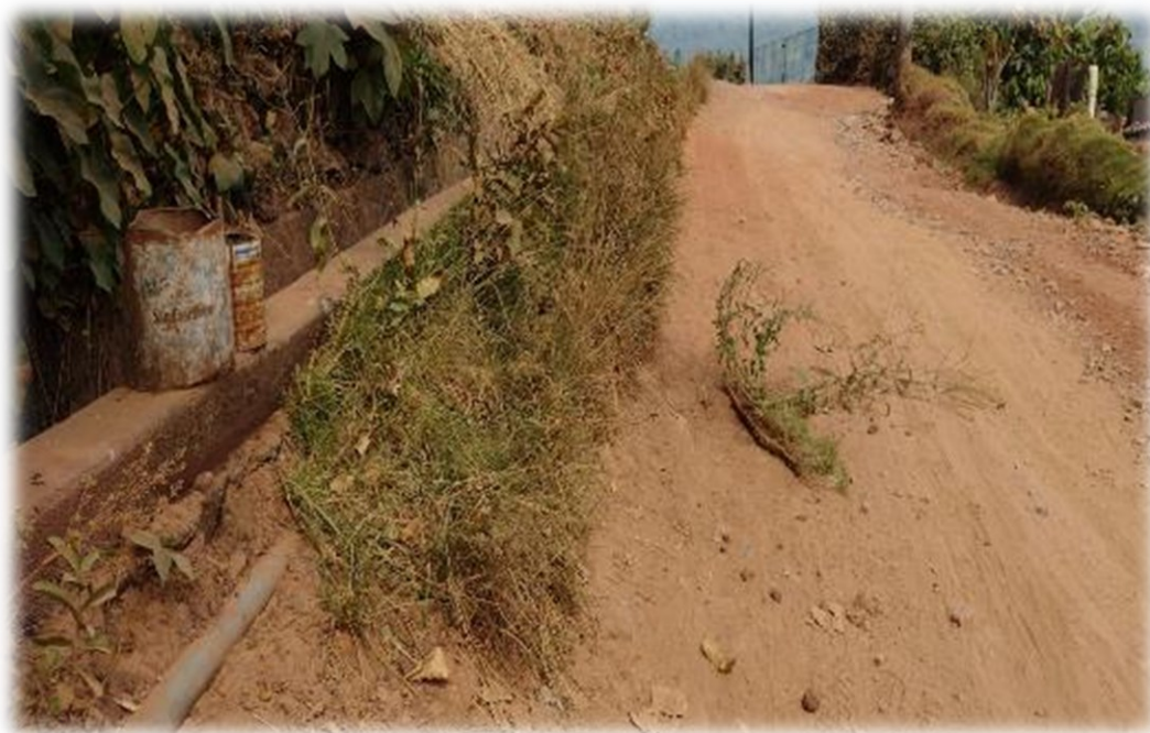
Vista de la red matriz del sistema de agua potable que se encuentra superficial y requiere el cambio y profundidad de la tubería.
