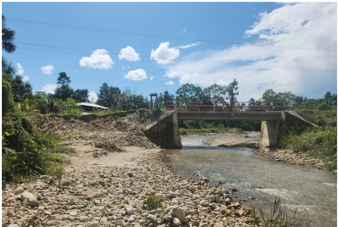
Fotografía 4: Vista lateral del puente carrozable que evidencia una falla inminente por erosión hídrica en el terraplén de acceso.
