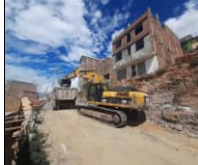
Problematica al momento de ejecucion de muros convencionales
