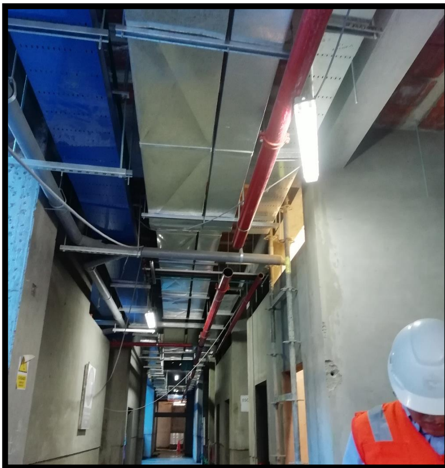
Red de tubería de Ventilación - Sector A-NIVEL 3
