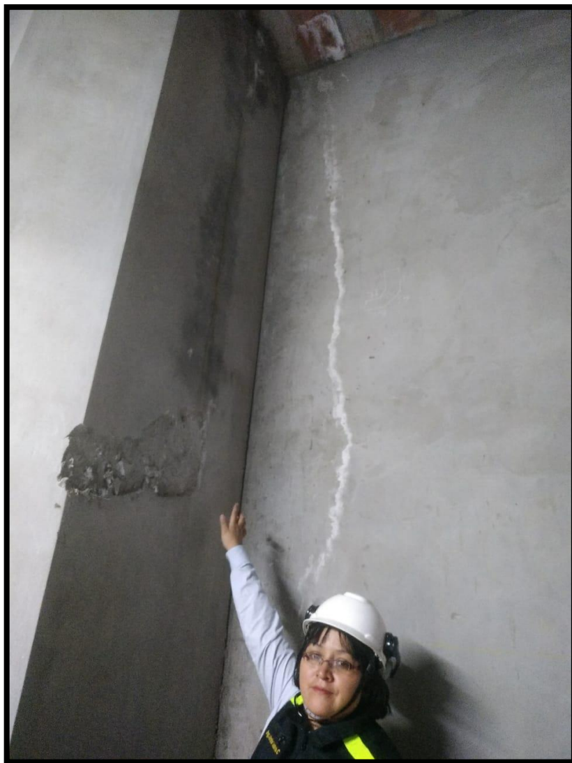
Se observa la existencia de filtración de agua por el techo.
