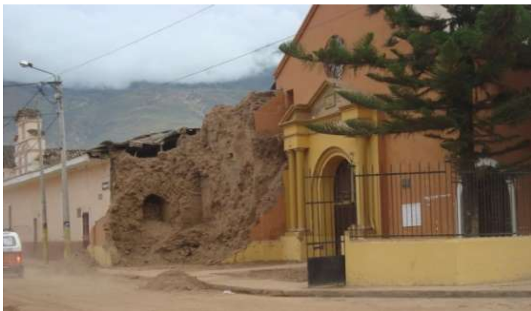
Figura 12 Colapso de torre
