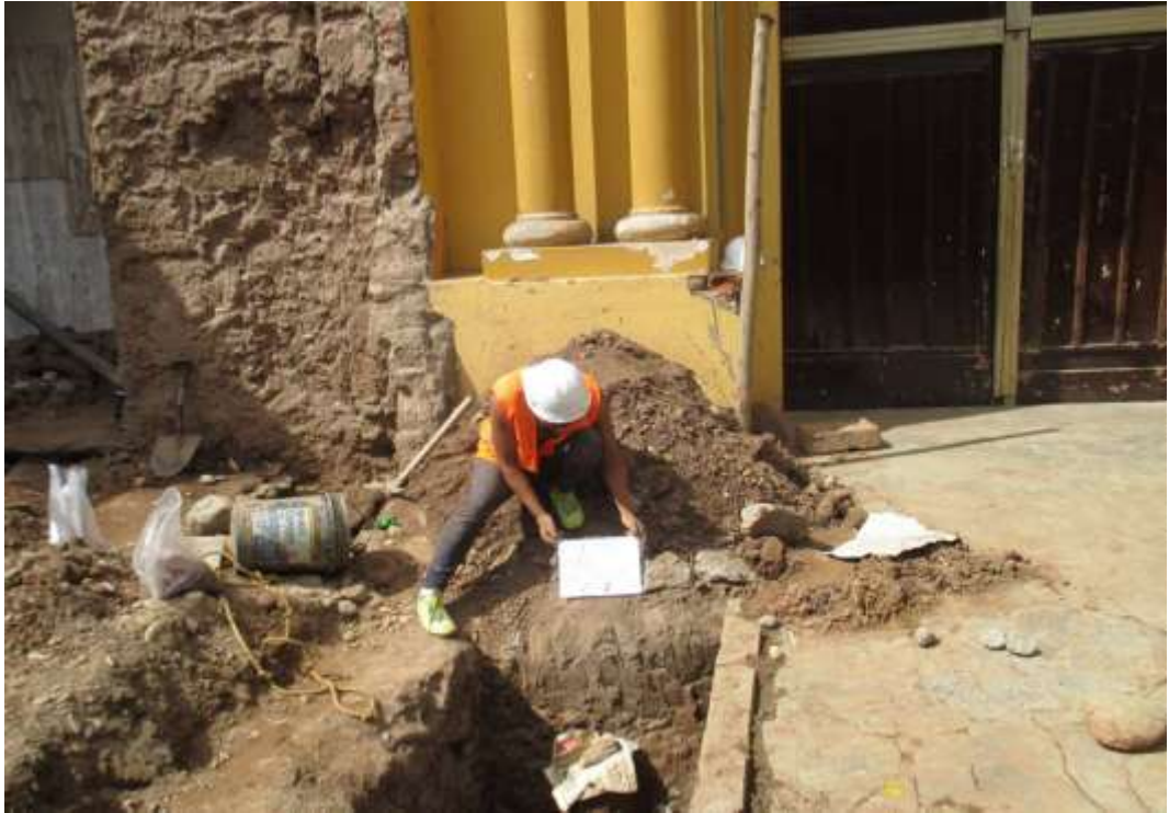
Nota. Observación de material y estado de cimentaciones.
